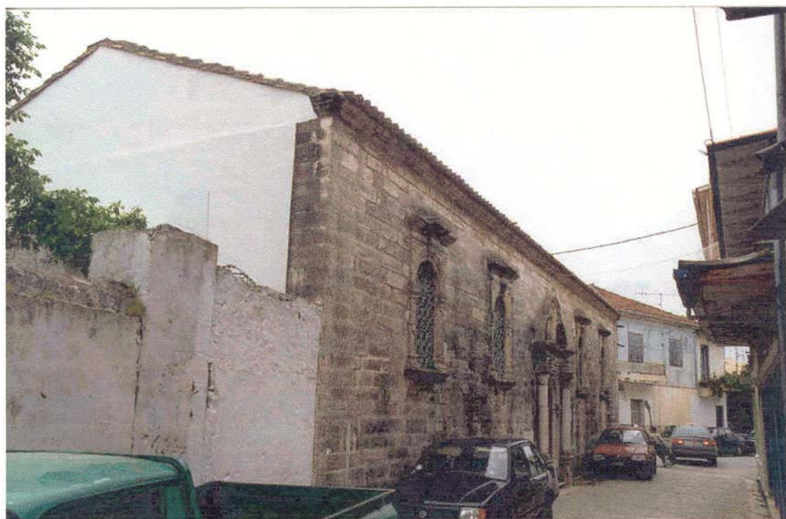
Φωτογραφία 20. Έντονες γκριζόμαυρες κρούστες παρουσιάζονται στις αρχιτεκτονικές επιφάνειες του κτιρίου.
