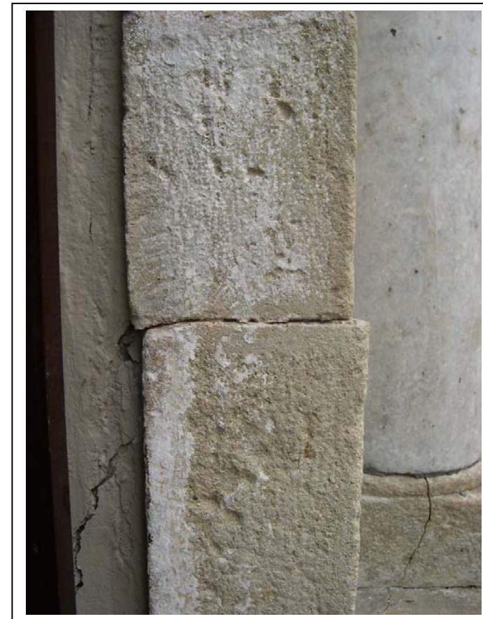
Φωτογραφία 11 Διατμητική αστοχία και ολίσθηση των πέτρινων διακοσμητικών περιθρωμάτων.
