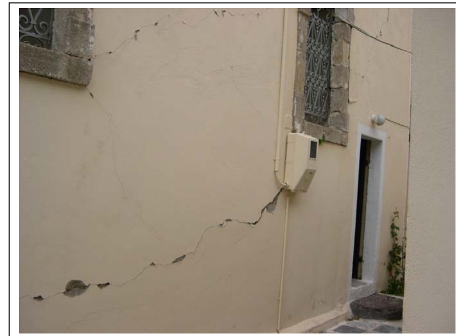
Φωτογραφία 74 : Αντιαισθητική τοποθέτηση μετρητή ΔΕΗ
