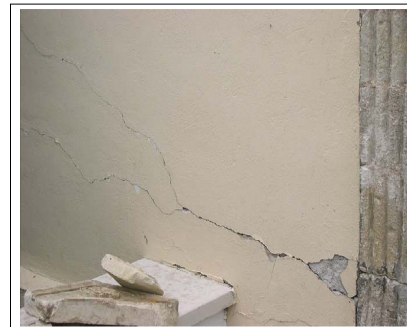
Φωτογραφία 20 : Αστοχία στη βάση του μεσημβρινού πεσσού Θραύσματα διακοσμητικών στοιχείων
