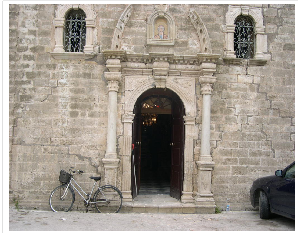
Φωτογραφία 5 Δυτική τοιχοδομή, κύρια όψη. Λοξές ρηγματώσεις.
