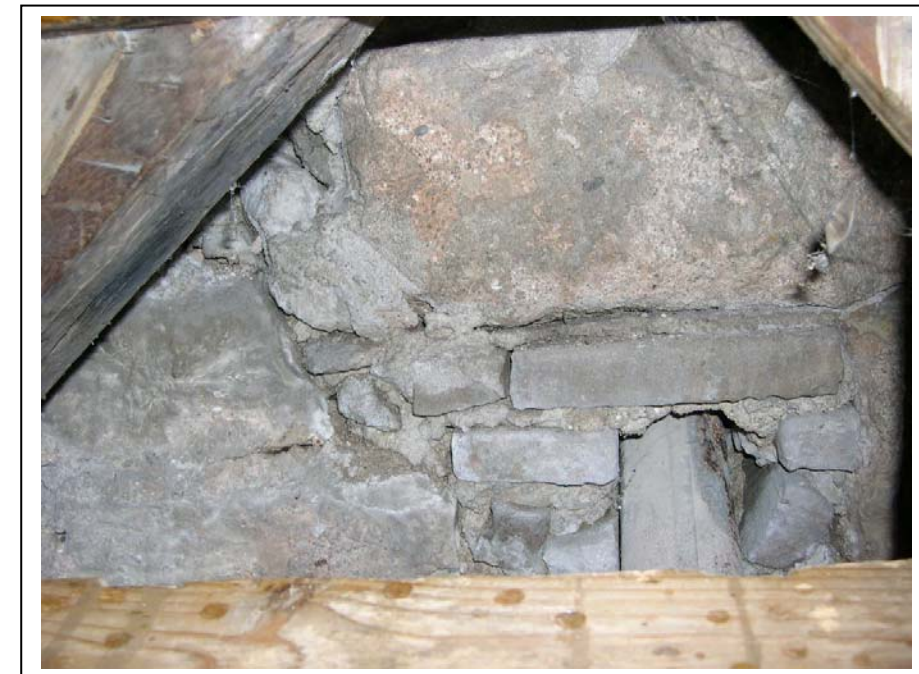
Φωτογραφία 56 : Τοπική αποδιοργάνωση της τοιχοδομής στη βόρεια πλευρά. Άποψη από θυρίδα της ξύλινης κατακόρυφης επένδυσης.
