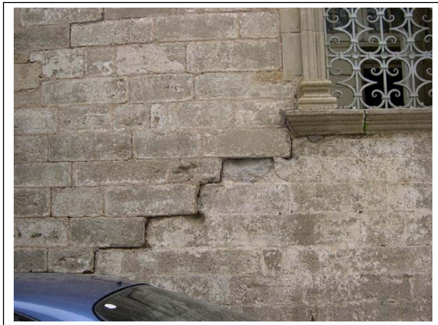
Φωτογραφία 17 : Διατμητική ρηγμάτωση και φούσκωμα στη βόρεια τοιχοδομή
