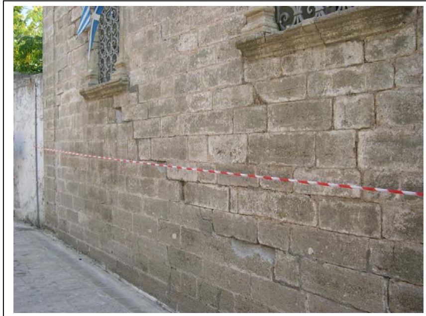
Φωτογραφία 1: Διατμητικές ρωγμές στην βόρεια τοιχοδομή
