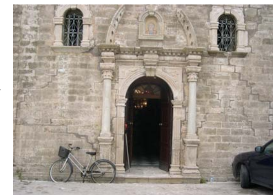
Φωτογραφία 3. Ρηγματώσεις αρκτικά, μεσημβρινά και δυτικά του Ναού
