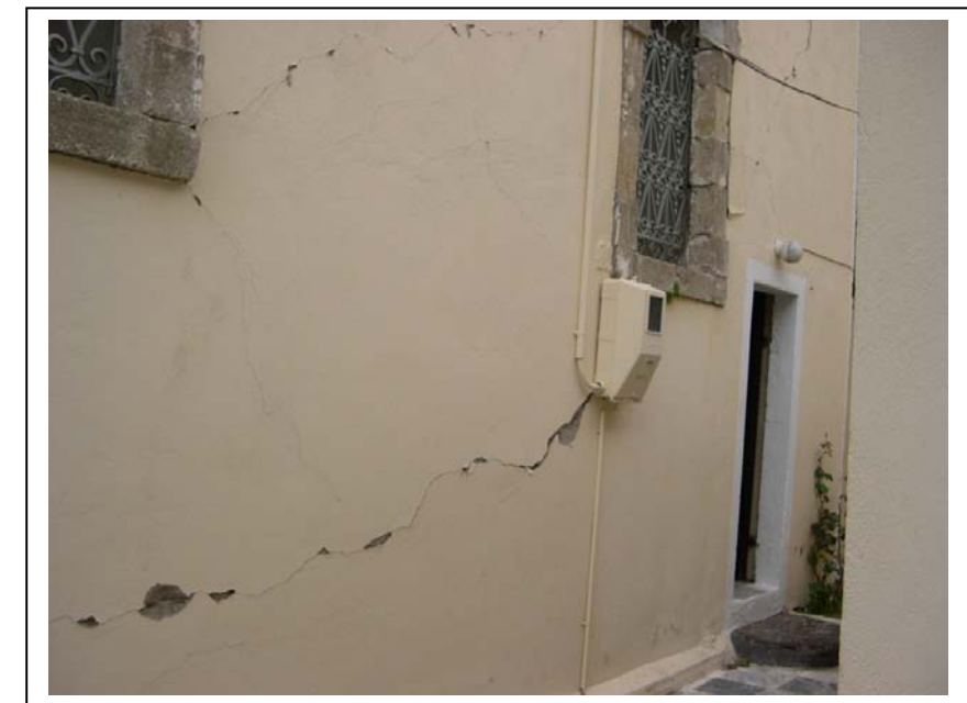
Φωτογραφία 24 : Εντυπωσιακή οριζόντια ρηγμάτωση της τοιχοδομής - Ακαλαίσθητη τοποθέτηση μετρητή ΔΕΗ
