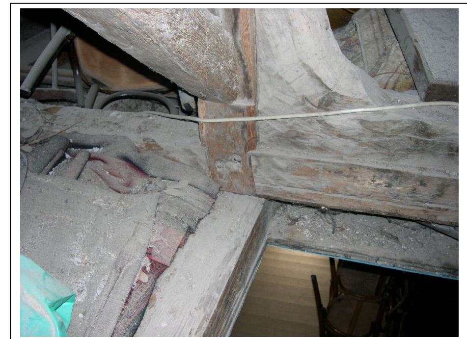
Φωτογραφία 52 : Φθορές σε ξύλινο στοιχείο στέγης
