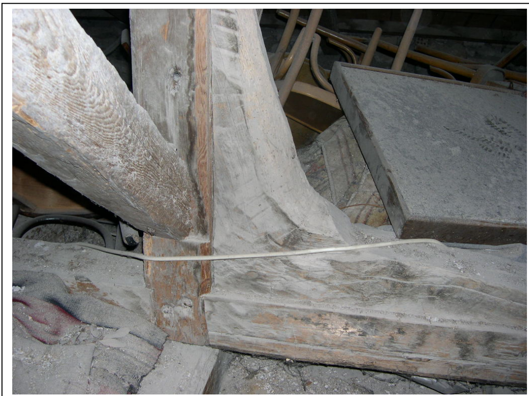
Φωτογραφία 45 : Ξύλινη γωνιακή ενίσχυση εγκάρσια στην ανάπτυξη του ζευκτού. Αποσπασματική και πρόχειρη ηλεκτρική καλωδίωση
