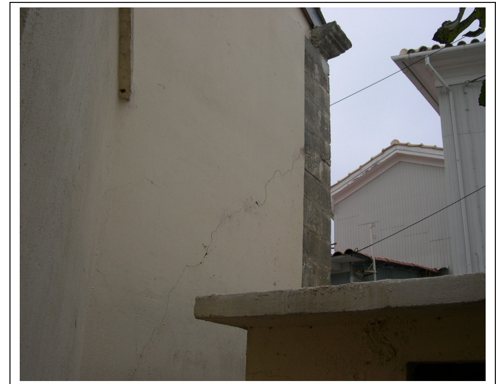
Φωτογραφία 23 : Ρηγμάτωση στην ανατολική όψη
