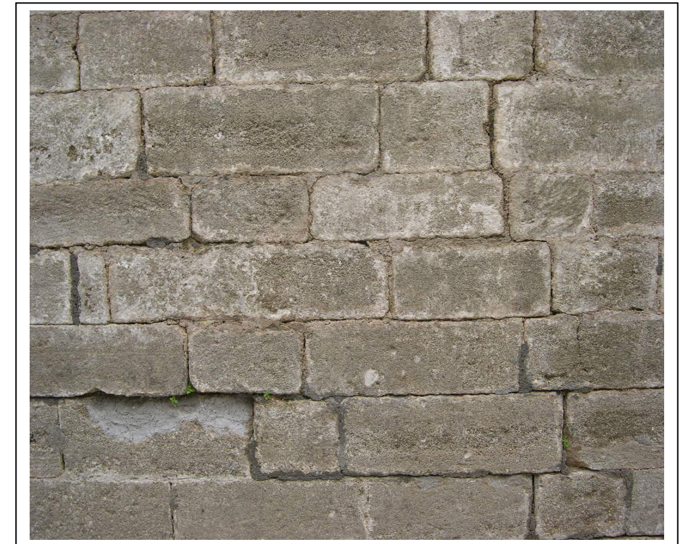
Φωτογραφία 16 : Ρηγμάτωση της ισοδομικής επιφάνειας και θραύση ακμής πορόλιθου στις θέσεις παλαιότερης επέμβασης
