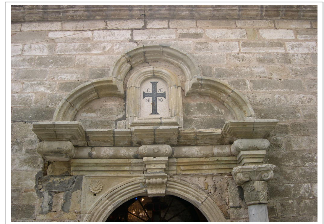
Φωτογραφία 15 : Αποκόλληση διακοσμητικών τμημάτων στην βορεινή είσοδο
