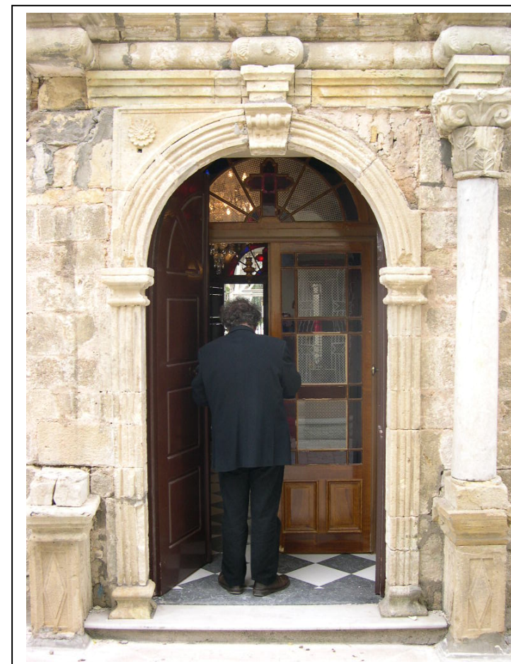
Φωτογραφία 39 : Άποψη πλάγιας εισόδου στη βόρεια πλευρά. Αποκόλληση διακοσμητικών στοιχείων
