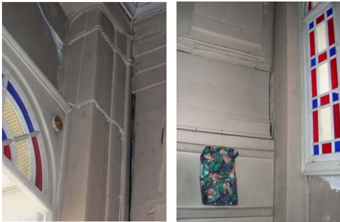
Φωτογραφία 10. Καλωδιώσεις στο ξύλινο περίβλημα
