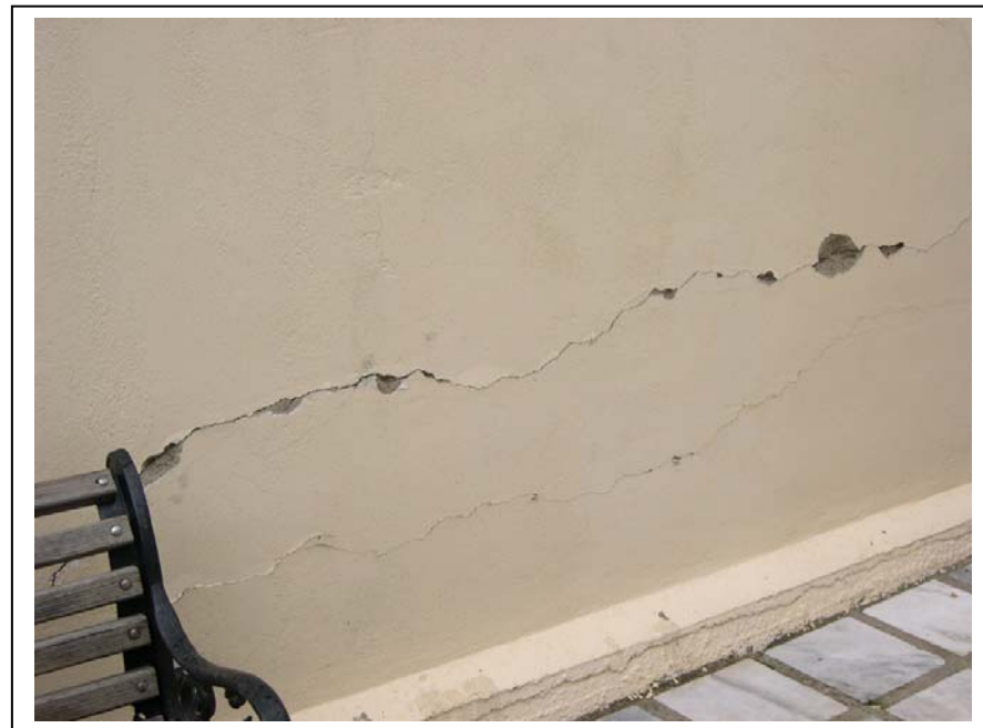
Φωτογραφία 25,26 : Οριζόντια ρηγμάτωση μεσημβρινής όψης
