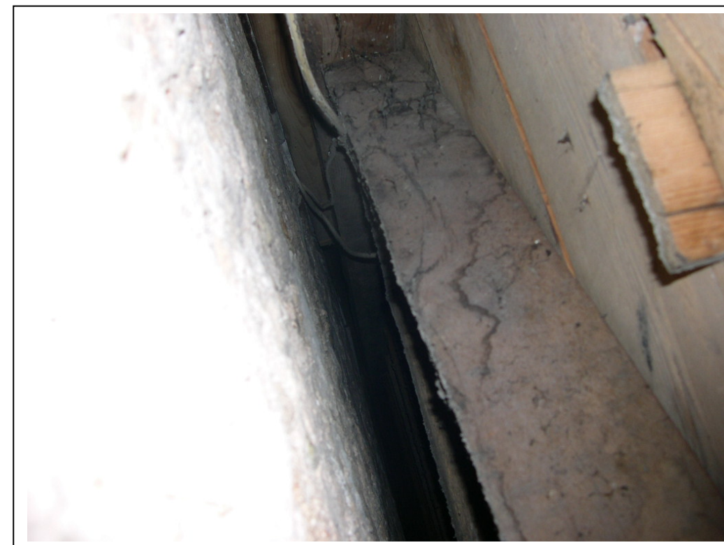
Φωτογραφία 59 : Άποψη της κατάστασης στο εσωτερικό μέρος της ξύλινης περιμετρικής επένδυσης των τοιχοδομών
