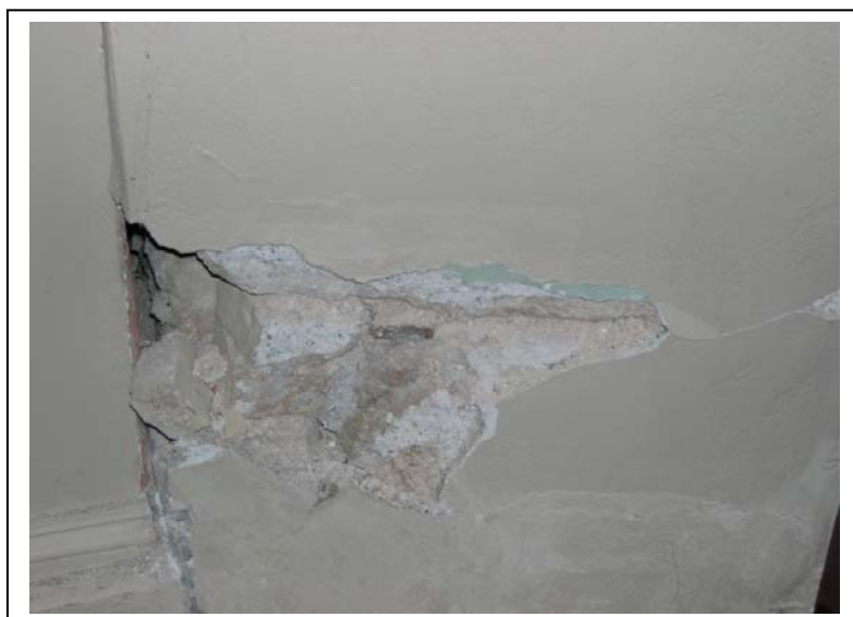
Φωτογραφία 38 : Εγκάρσια ρηγμάτωση στους επιμήκεις πεσσούς στη θέση των πλαγίων εισόδων
