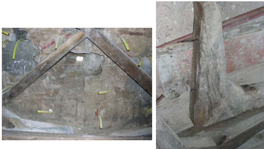
Φωτογραφία 5. Άποψη αποσαθρωμένου διατμητικού στοιχείου τοιχοδομής
