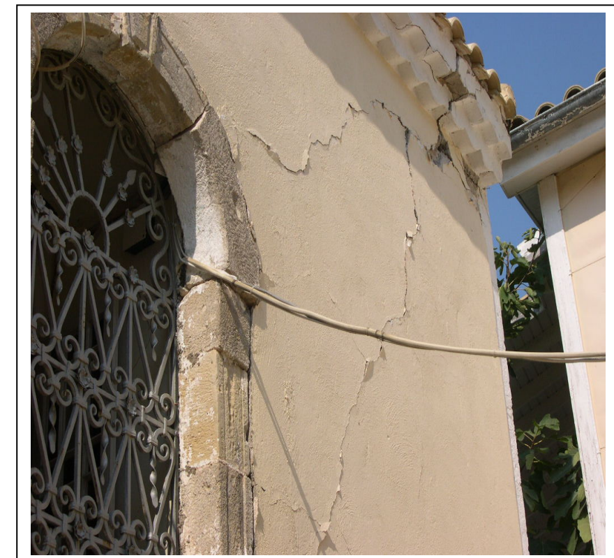
Φωτογραφία 8 Διαγώνιες ρηγματώσεις στην μεσημβρινή τοιχοδομή Ν.Α.
