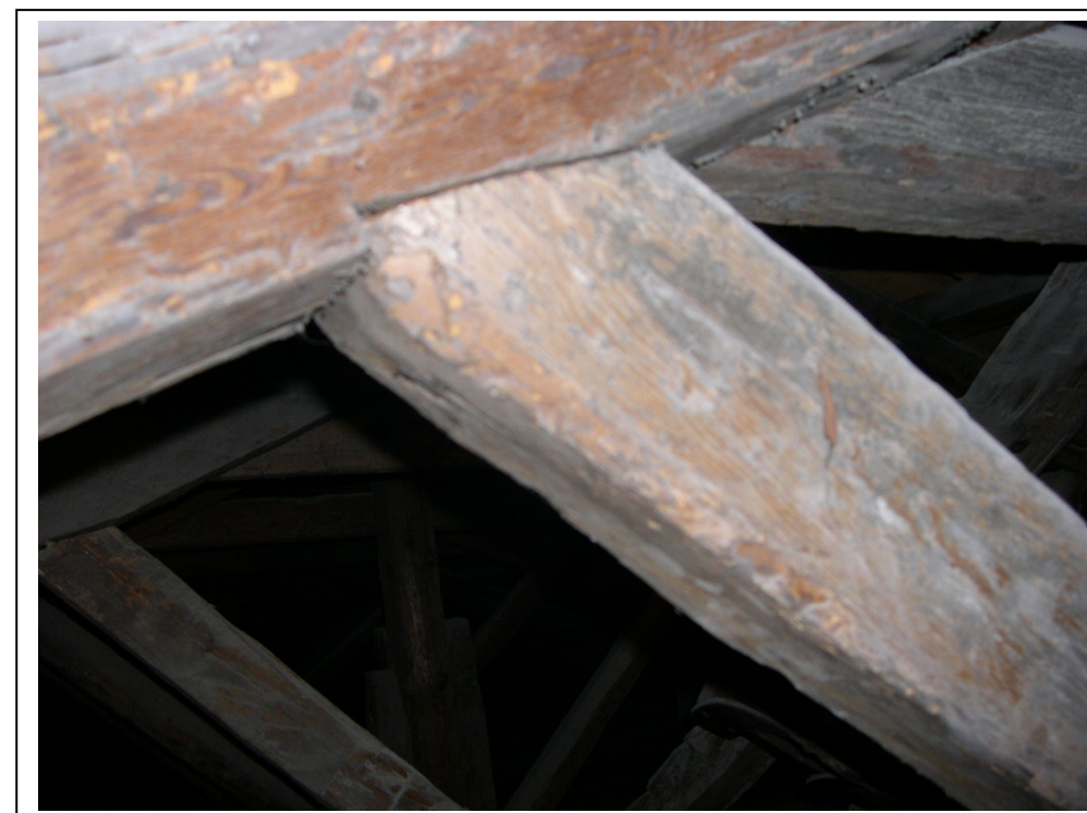
Φωτογραφία 48: Φθορές στα ξύλινα ζευκτά
