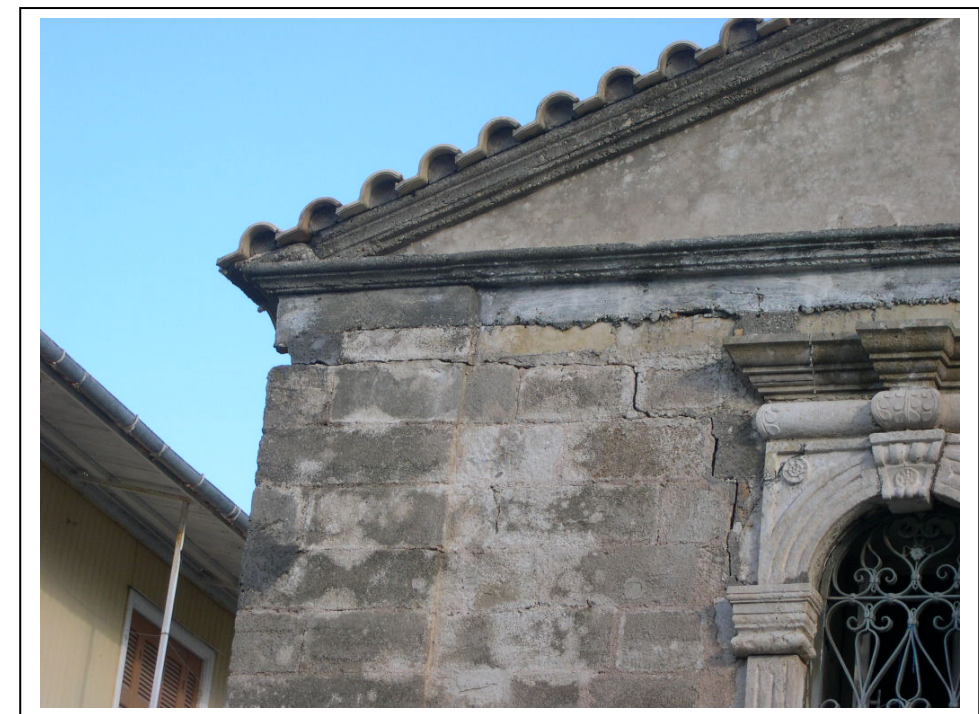
Φωτογραφία 28 : Η εμφανής διαζωμάτωση από οπλισμένο σκυρόδεμα στη βάση του δυτικού αετώματος χρήζει επέμβασης για αισθητική αποκατάσταση.
