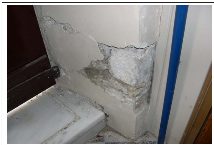
Φωτογραφία 37 : Εγκάρσια ρηγμάτωση στους επιμήκεις πεσσούς στη θέση των πλαγίων εισόδων
