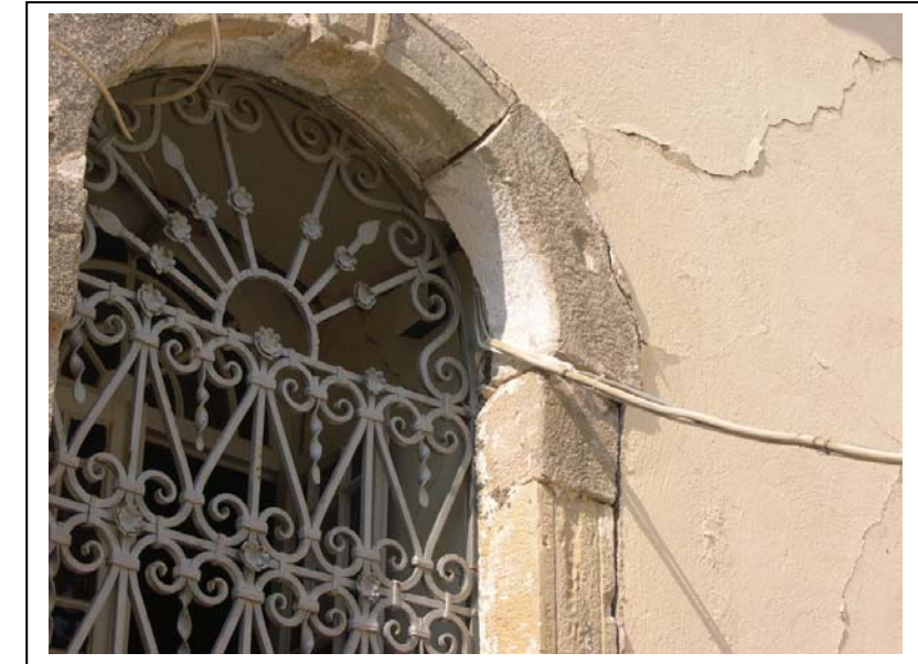
Φωτογραφία 7 Ρηγμάτωση στην νότια τοιχοδομή, διατάραξη περιθρωμάτων
