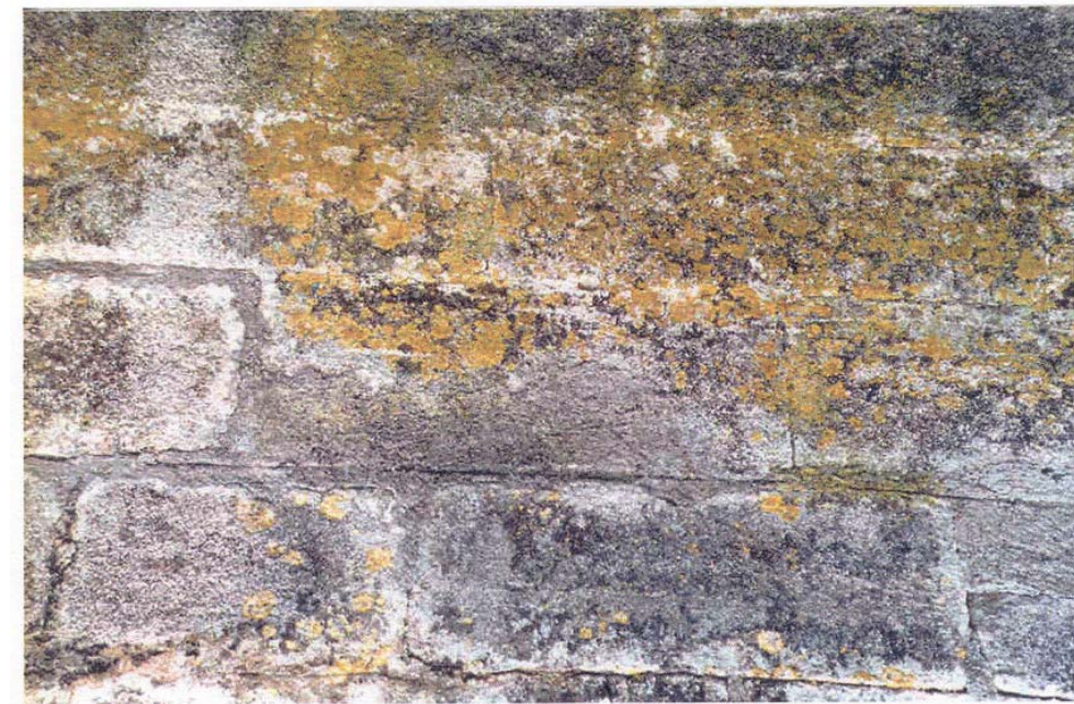
Φωτογραφία 16. Λεπτομέρεια της επιφάνειας με έντονη ανάπτυξη βιολογικής δραστηριότητας. Διακρίνονται επίσης ενσφραγίσεις των αρμών.
