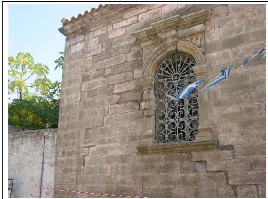
Φωτογραφία 2: Διατμητική αστοχία στην βόρεια τοιχοδομή Β.Α.
