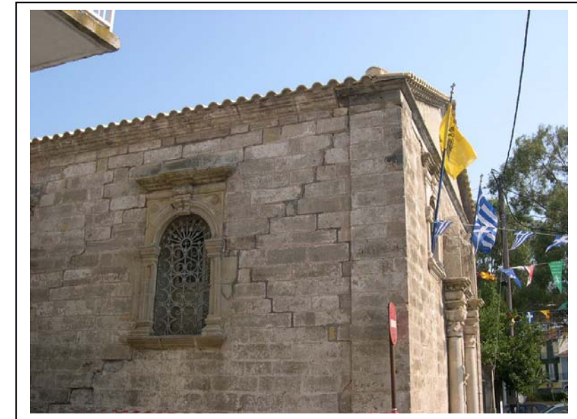
Φωτογραφία 3: Διατμητική αστοχία στην βόρεια τοιχοδομή Β.Δ.
