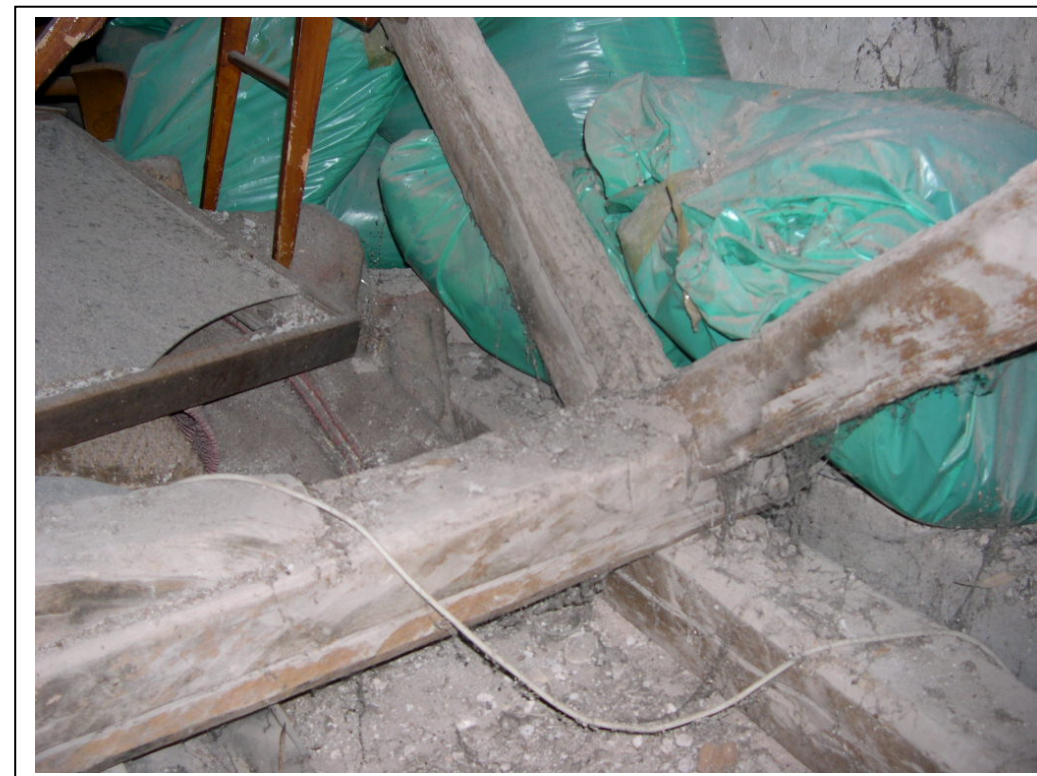
Φωτογραφία 47: Φθορές στα ξύλινα ζευκτά. Πρόχειρη ηλεκτρική καλωδίωση.
