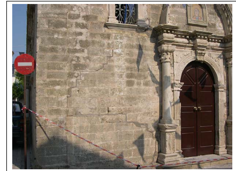
Φωτογραφία 4: Διατμητική αστοχία στην δυτική τοιχοδομή, κύρια όψη.
