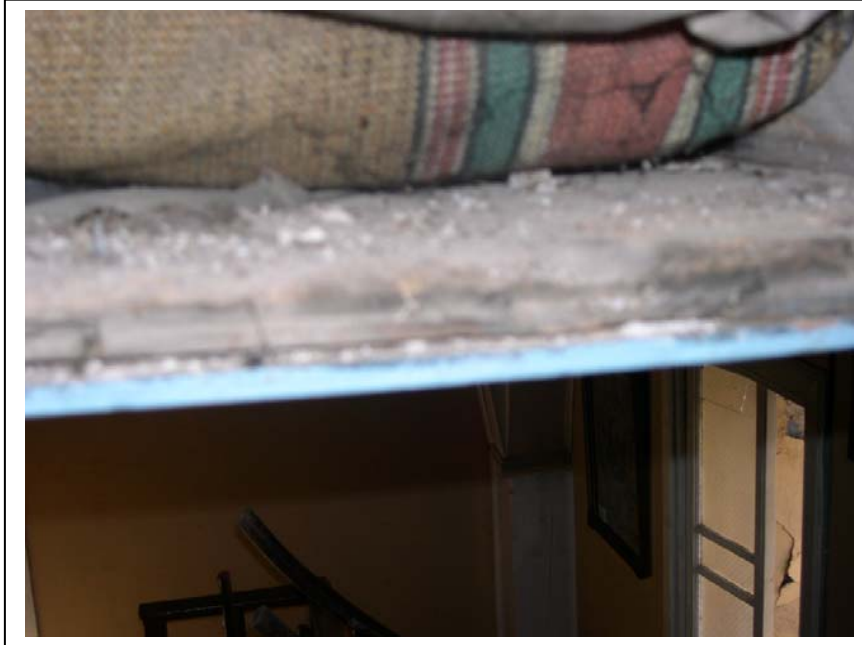
Φωτογραφία 53 : Κατάσταση ξύλινης οροφής γυναικωνίτη
