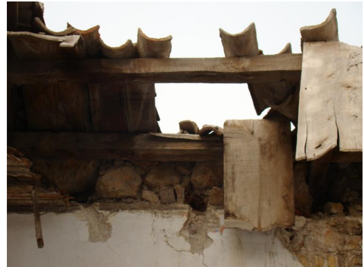
Εικ.90 Άποψη της στέγης: κατεστραμμένο τμήμα της στέγης στον χώρο VI.
