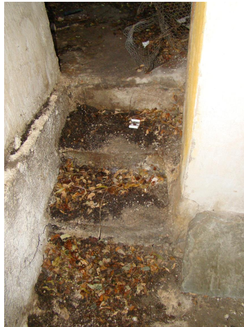
Εικ.88 Τα δύο σκαλοπάτια που συνδέουν την αυλή με το υπόγειο. (μεταγενέστερη προσθήκη)
