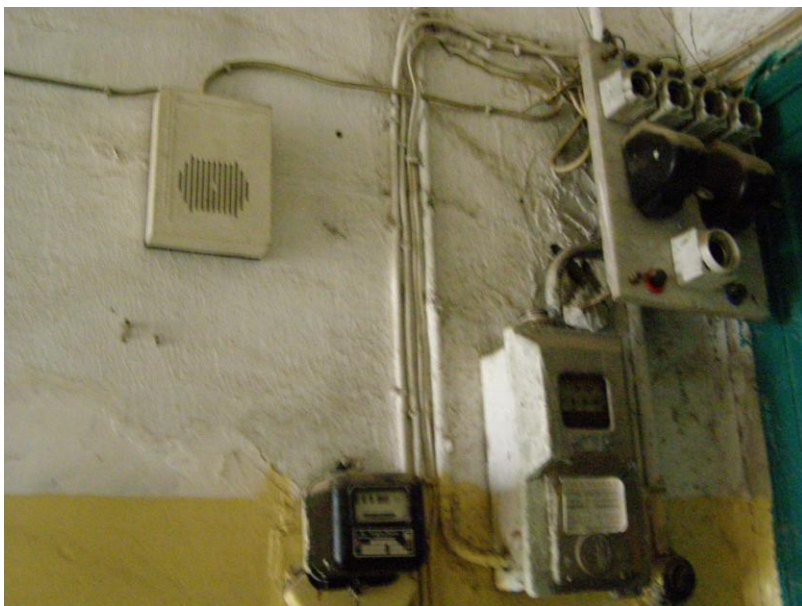
Εικ.120 Ηλεκτρικός πίνακας του κτηρίου στον χώρο IV του ισόγειου.
