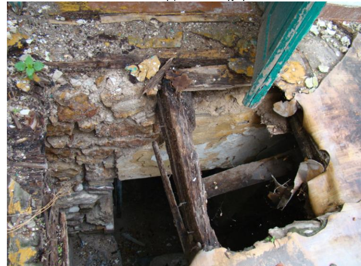
Εικ.78 Κατεστραμμένο τμήμα δοκού νοτιοανατολικά του χώρου VI.
