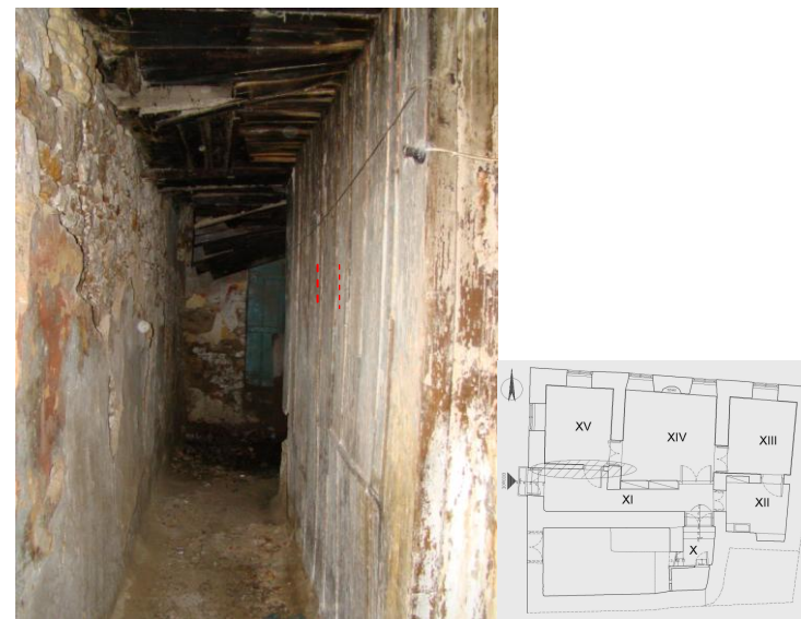
Εικ.146 Κατεστραμμένα τμήματα του μεσοπατώματος στον χώρο XI.
