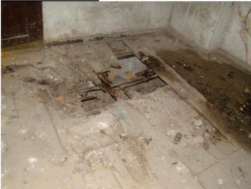
Εικ.33 Ξύλινο δάπεδο χώρου VIII του ισογείου με φθορές στην νοτιοδυτική γωνία.
