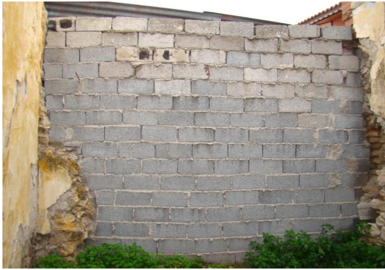
Εικ.127 Κατεστραμμένη η ανατολική τοιχοποιία του χώρου III στο ισόγειο.
