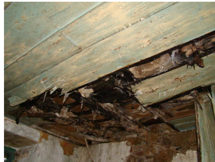
Εικ.103 Κατεστραμμένη οροφή στον χώρο XIII.
