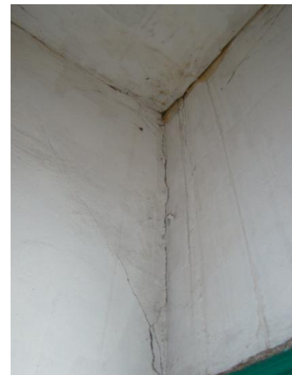
Εικ.142 Ρωγμές στα σημεία σύνδεσης των τοιχοποιιών.
