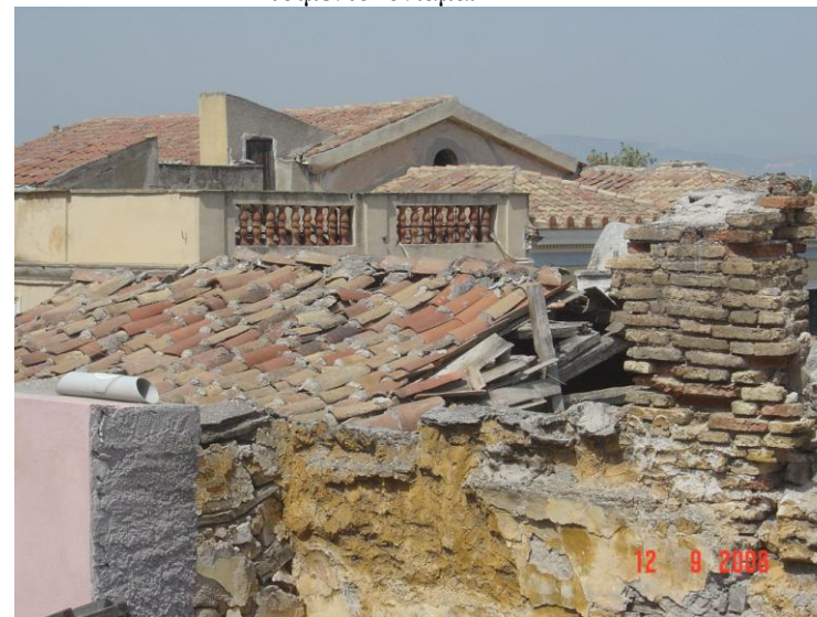
Εικ.58 Νοτιοανατολικό τμήμα της στέγης που έχει υποστεί καθίζηση.
