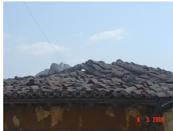
Εικ.57 Δυτική άποψη της στέγης όπου είναι εμφανή η παρέμβαση από τσιμεντοκονίαμα.
