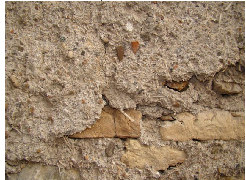
Εικ.68 Αποσάθρωση κονιάματος στον δυτικό εξωτερικό μαντρότοιχο του κτηρίου.
