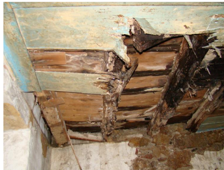
Εικ.43 Κατεστραμμένο τμήμα της οροφής βορειοανατολικά του χώρου XIII.
