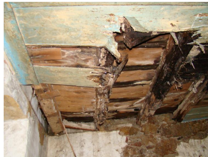
Εικ.145 Κατεστραμμένο τμήμα μεσοπατώματος στην βορειοανατολική γωνία του χώρου XIII.
