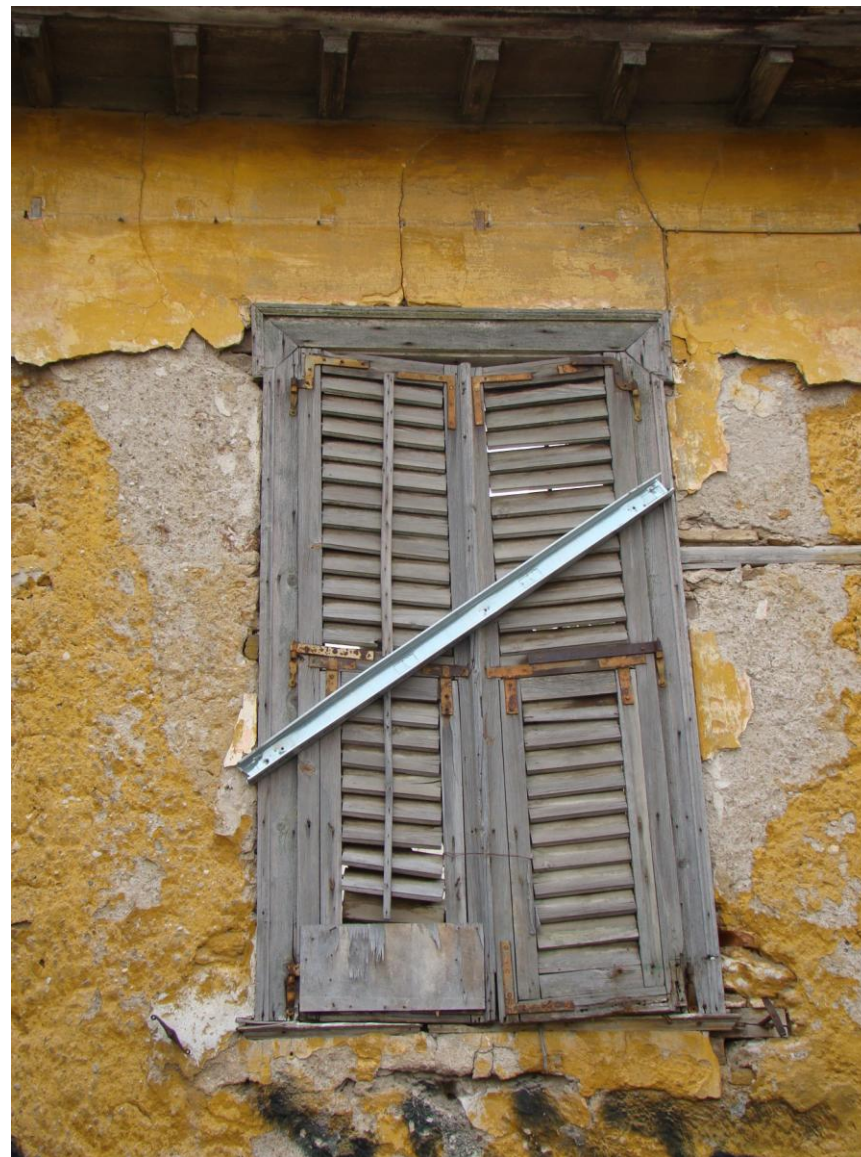
Εικ.106 Αποσάθρωση επιχρίσματος στην βόρεια όψη του κτιρίου (άνοιγμα 07).
