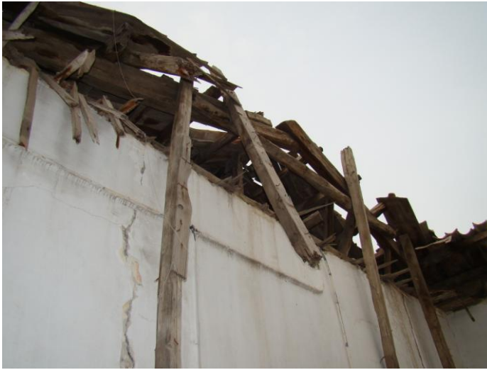
Εικ.130 Κατάρρευση δοκαριών στον χώρο III του ισογείου.
