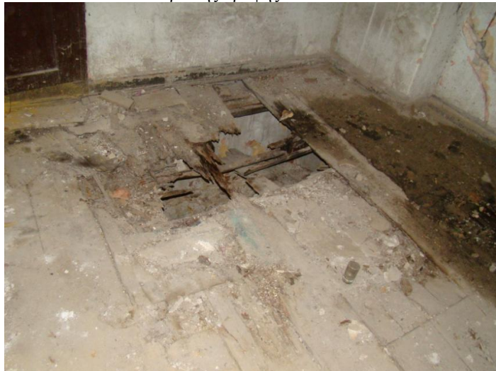
Εικ.76 Καταστροφή τμήματος στην νοτιοδυτική γωνία του χώρου VIII.
