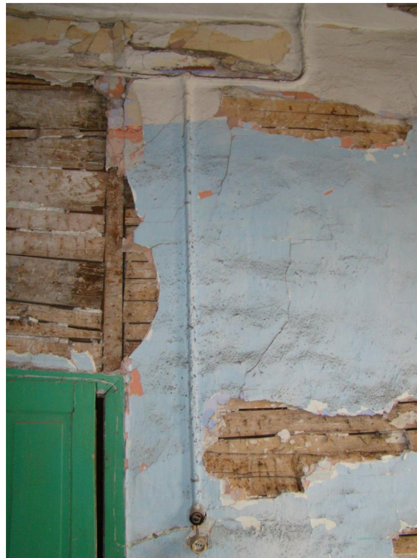
Εικ.119 Ρευματοδότης στον νότιο τοίχο του χώρου VII στο ισόγειο.
