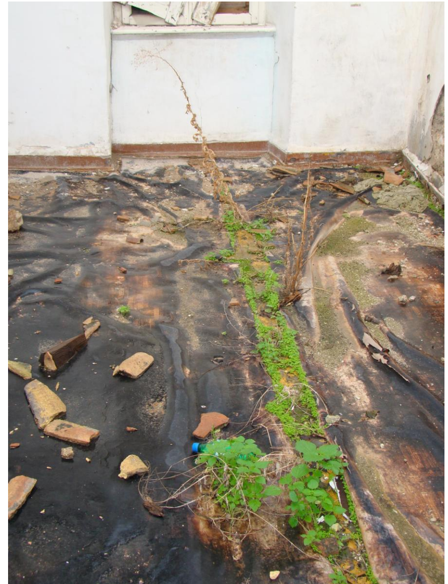
Εικ.34 Δάπεδο καλυμμένο με μουσαμά στον χώρο VI του ισογείου.
