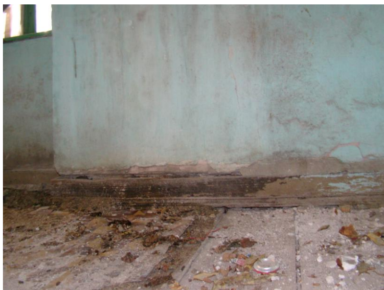
Εικ.73 Κύρτωση πατώματος στον χώρο V του ισογείου.
