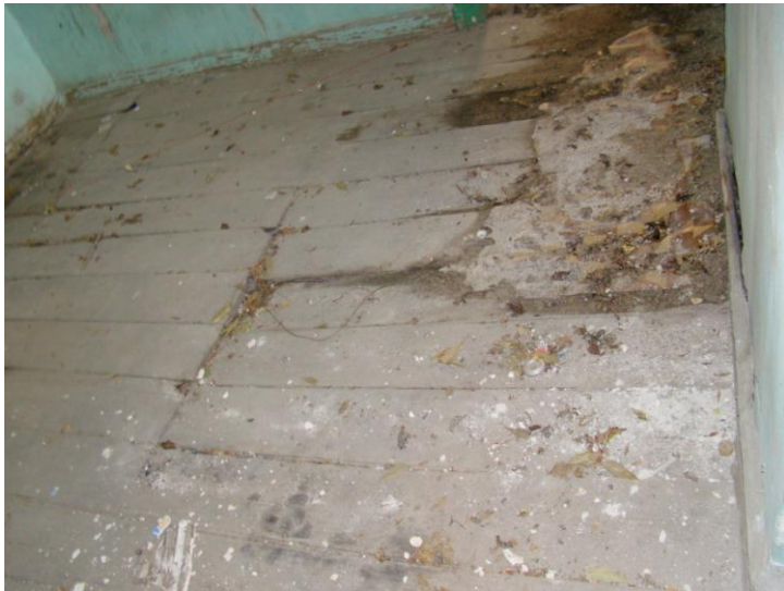
Εικ.75 Ξύλινο δάπεδο του χώρου V: όπου πάνω του έχει πέσει τμήμα του σοβά της οροφής.
