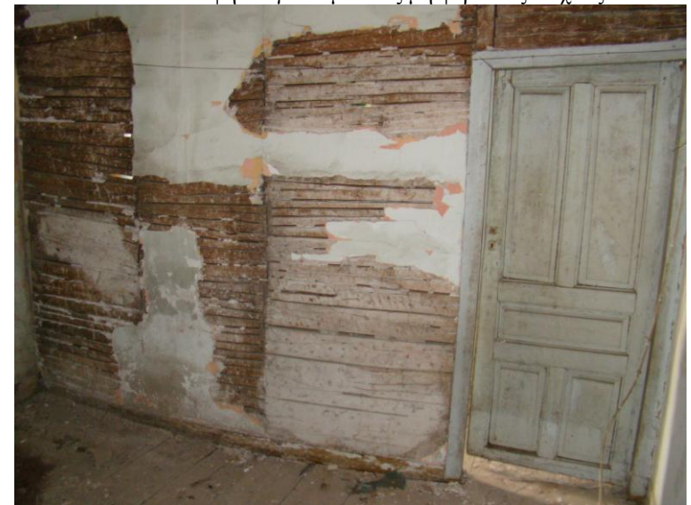
Εικ.98 Καθίζηση τμήματος του δαπέδου στον χώρο VIII.
