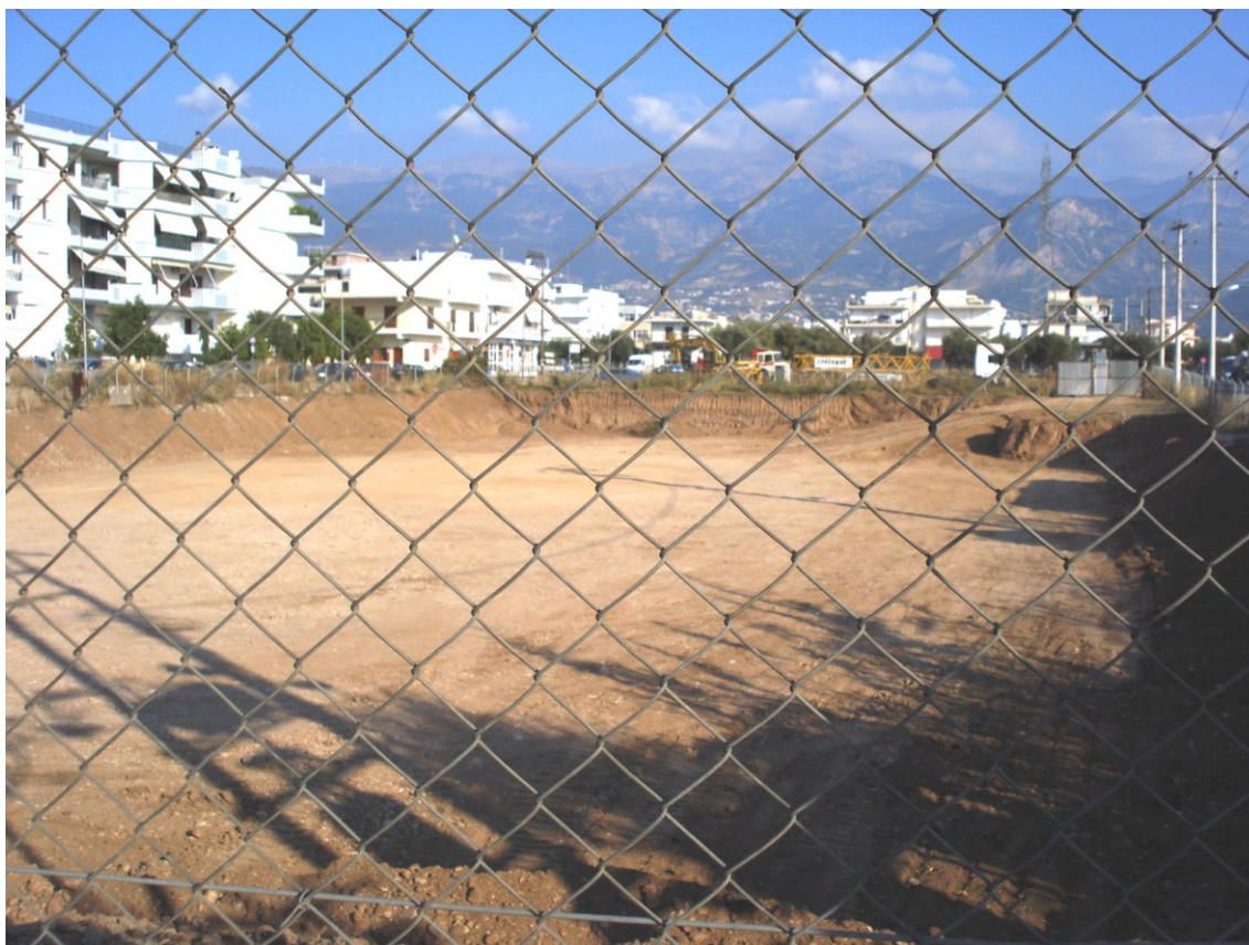
Εικόνα 7- 1 Μετά το πέρας των εκσκαφών, η επιφάνεια του χώματος οριζοντιώνεται και «λειαινεται», ώστε να είναι έτοιμη για την διάστρωση του μπετόν καθαριότητας [προσωπικό αρχείο 46]
