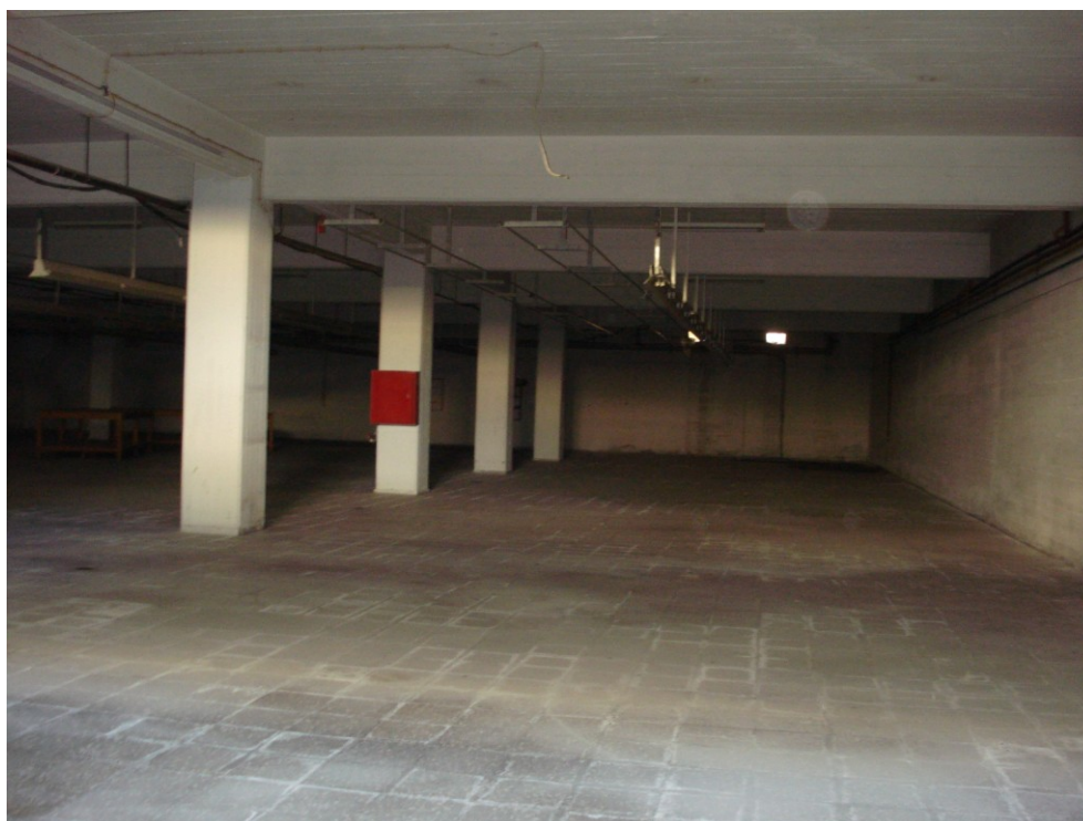
Εικόνα 6- 3 Ο χώρος του υπογείου. Διακρίνονται τα φθαρμένα μωσαϊκά πλακάκια, τα υποστυλώματα καθώς επίσης και τα ίχνη του ξυλότυπου πάνω στο σκυρόδεμα της οροφής και των τοιχίων. [προσωπικό αρχείο]
