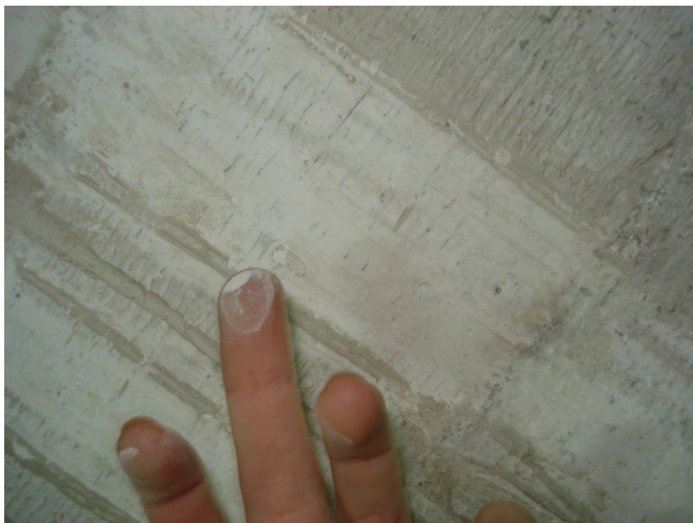
Εικόνα 6- 2 Η στρώση ασβέστη ως επίχρωση στις επιφάνειες των τοιχίων οπλ. Σκυροδέματος στον χώρο του υπογείου [προσωπικό αρχείο] .
