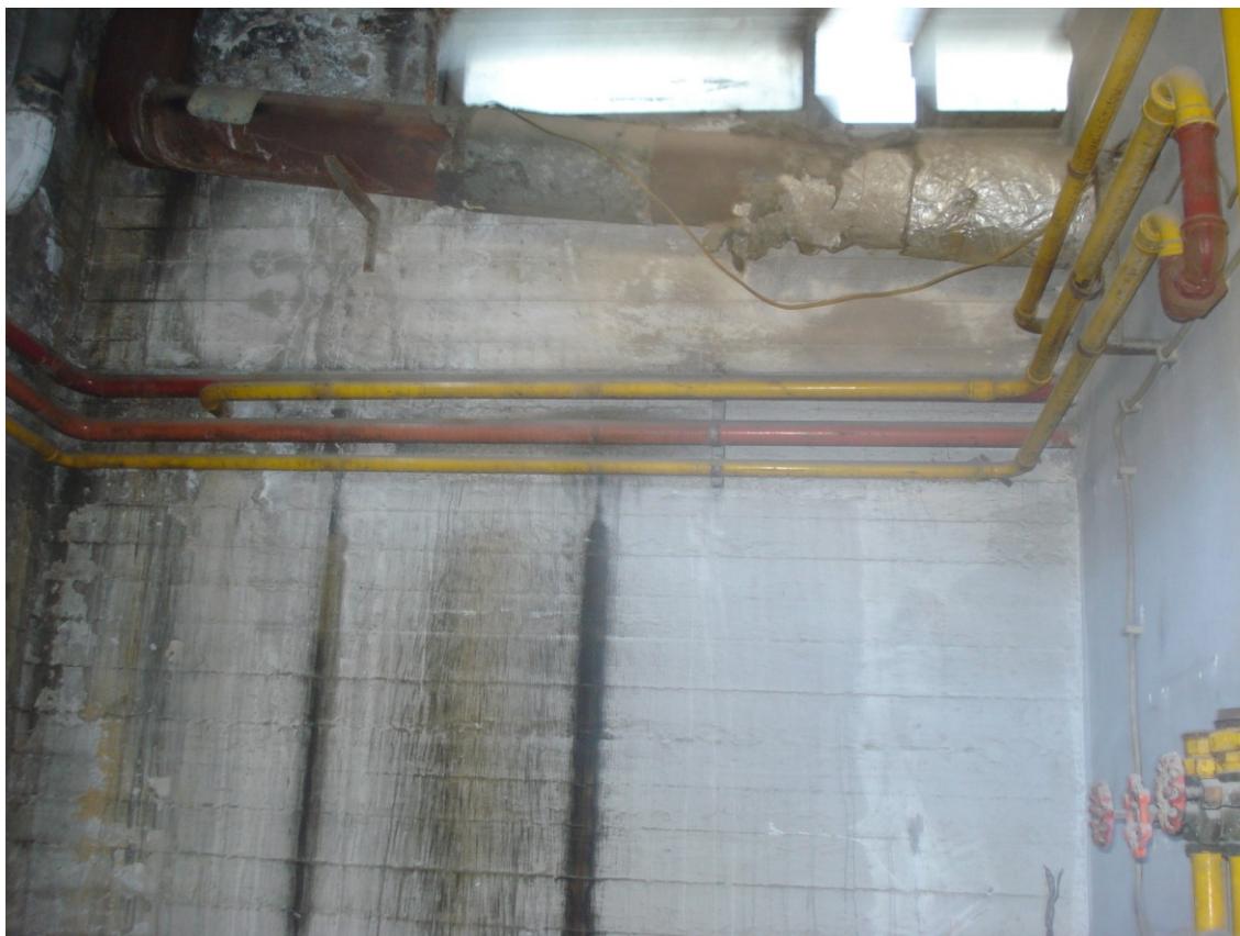
Εικόνα 6- 9 Καπνοδόχος εκπομπής ρύπων λέβητα. Στο χώρο παρατηρείται εμφάνιση υγρασίας καθώς στους άνω ορόφους υπάρχουν οι εγκαταστάσεις των λουτρών [προσωπικό αρχείο] .
