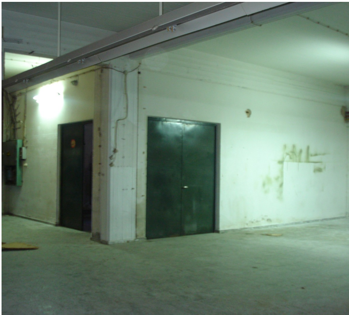
Εικόνα 6- 7 Ο χώρος λεβητοστασίου με πυράντοχες πόρτες και διαχωριστικούς τοίχους από δρομική οπτοπλινθοδομή επιχρισμένη [προσωπικό αρχείο] .
