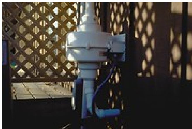
Εικόνα 5- 14 Αντλία εξωτερικά του σπιτιού [αναφορά 41] .
