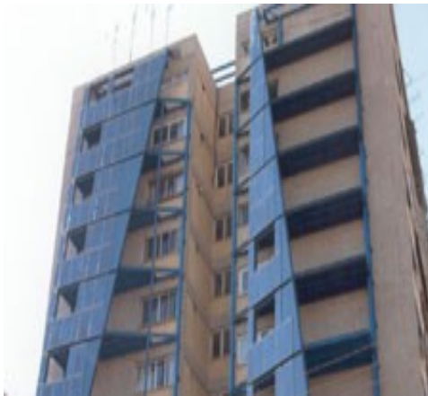
Εγκατάσταση διασυνδεδεμένων φωτοβολταϊκών συστημάτων σε πολυκατοικία στην περιοχή Ταύρου, Αττικής, ισχύος 11.9KW
