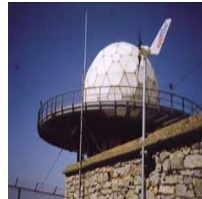
Ανεμογεννήτρια για αναμεταδότη της πυροσβεστικής
