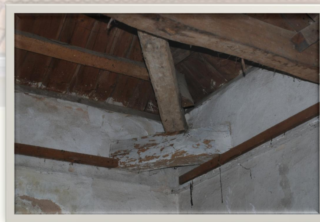
Εικ. 6.16: Τοπική ενίσχυση λόγω υποχωρήσεις
