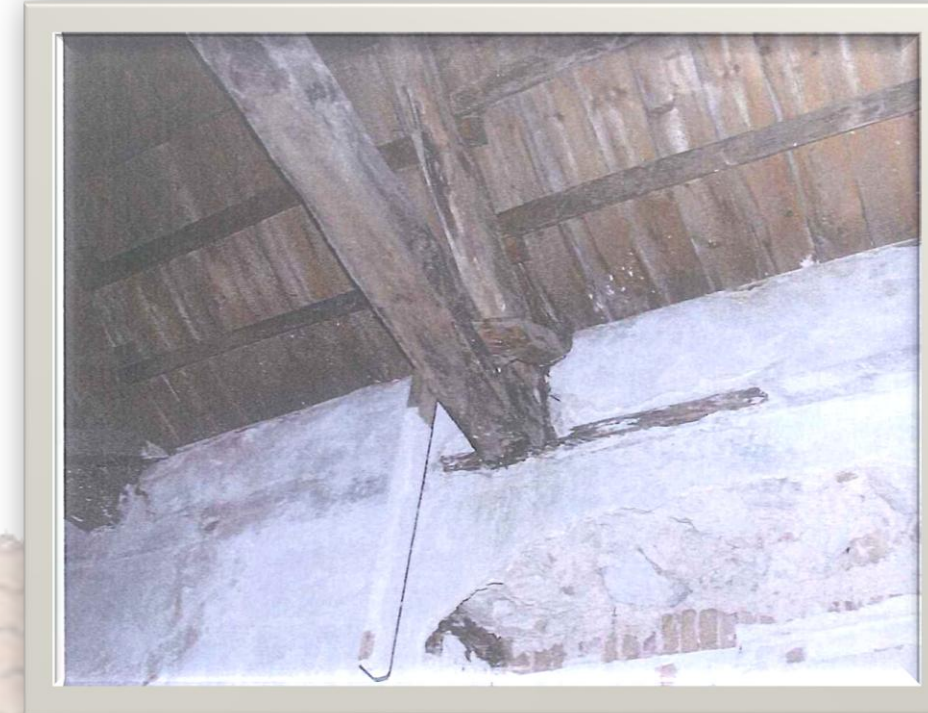
Εικ 6.7: Διαβρώσεις των δοκών του ορόφου
