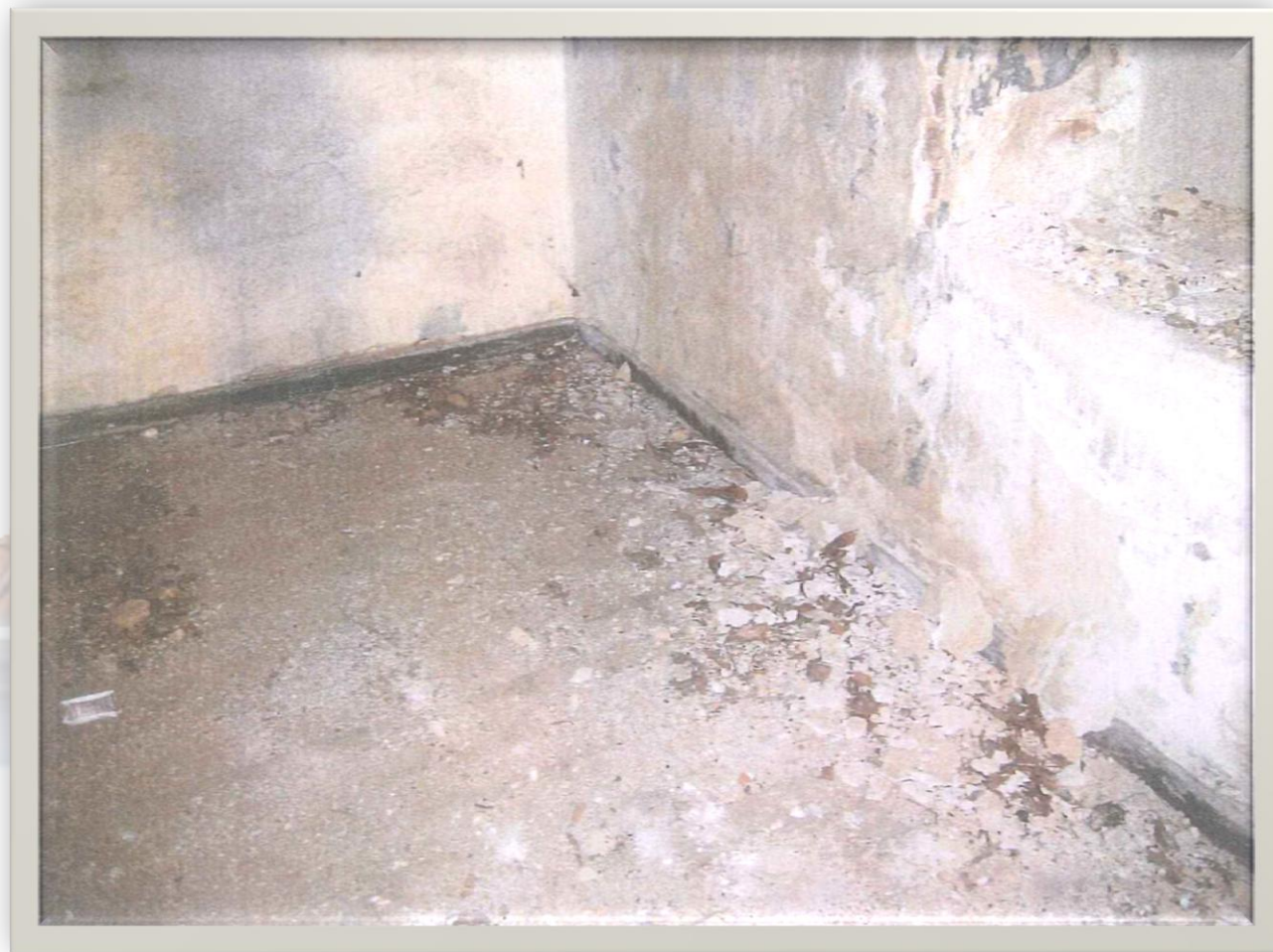
Εικ. 6.3: Αποκόλληση του επιχρίσματος
