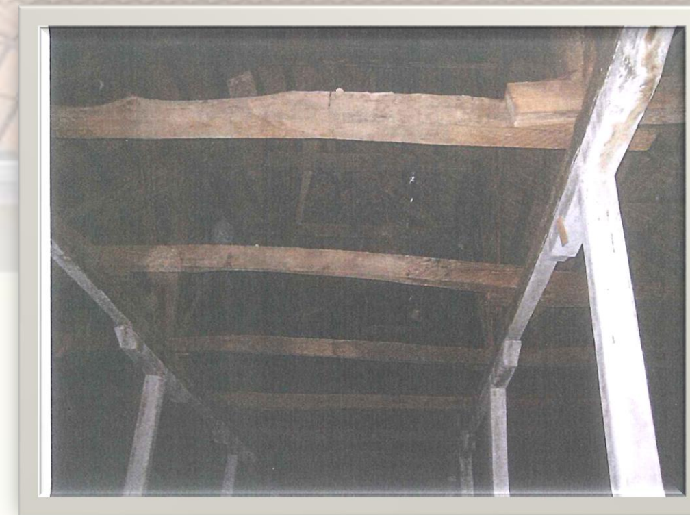
Εικ. 6.8: Στρέβλωση των δοκών του ορόφου
