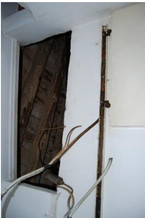
ΕΙΚΟΝΑ 62 : ΗΛΕΚΤΡΟΛΟΓΙΚΕΣ ΕΓΚΑΤΑΣΤΑΣΕΙΣ ΚΑΤΑΣΤΗΜΑΤΩΝ
