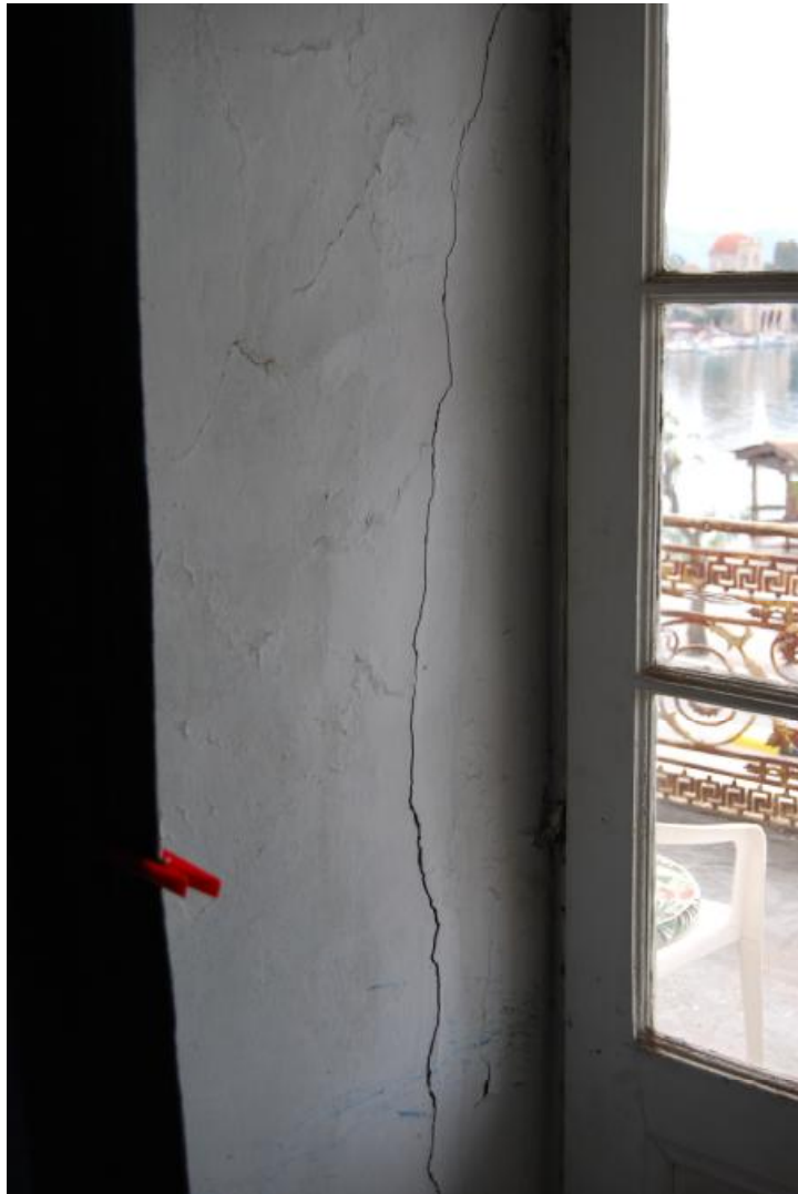
ΕΙΚΟΝΑ 14:ΡΩΓΜΗ ΤΟΙΧΟΥ ΣΕ ΜΠΡΟΣΤΙΝΟ ΔΩΜΑΤΙΟ Α΄ΟΡΟΦΟΥ
