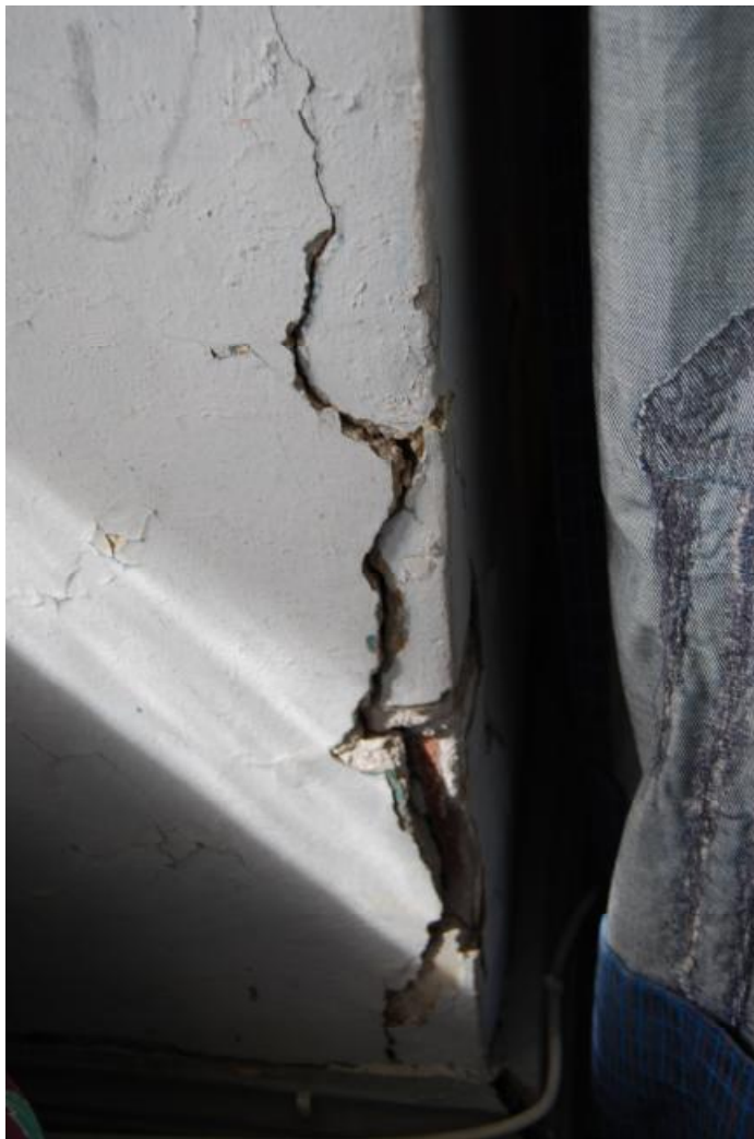
ΕΙΚΟΝΑ 13:ΡΩΓΜΗ ΤΟΙΧΟΥ ΣΕ ΜΠΡΟΣΤΙΝΟ ΔΩΜΑΤΙΟ Α΄ΟΡΟΦΟΥ
