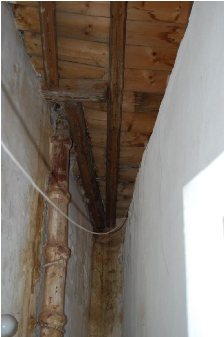
ΕΙΚΟΝΑ 58 : ΑΠΟΧΕΤΕΥΣΗ ΣΤΟ Β΄ΚΤΙΡΙΟ
