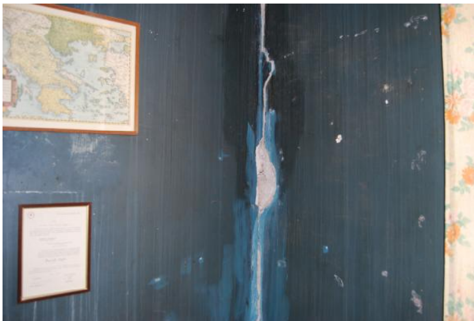
ΕΙΚΟΝΑ 16: ΡΩΓΜΗ ΣΕ ΤΟΙΧΟ ΣΤΟΝ Β'ΟΡΟΦΟ
