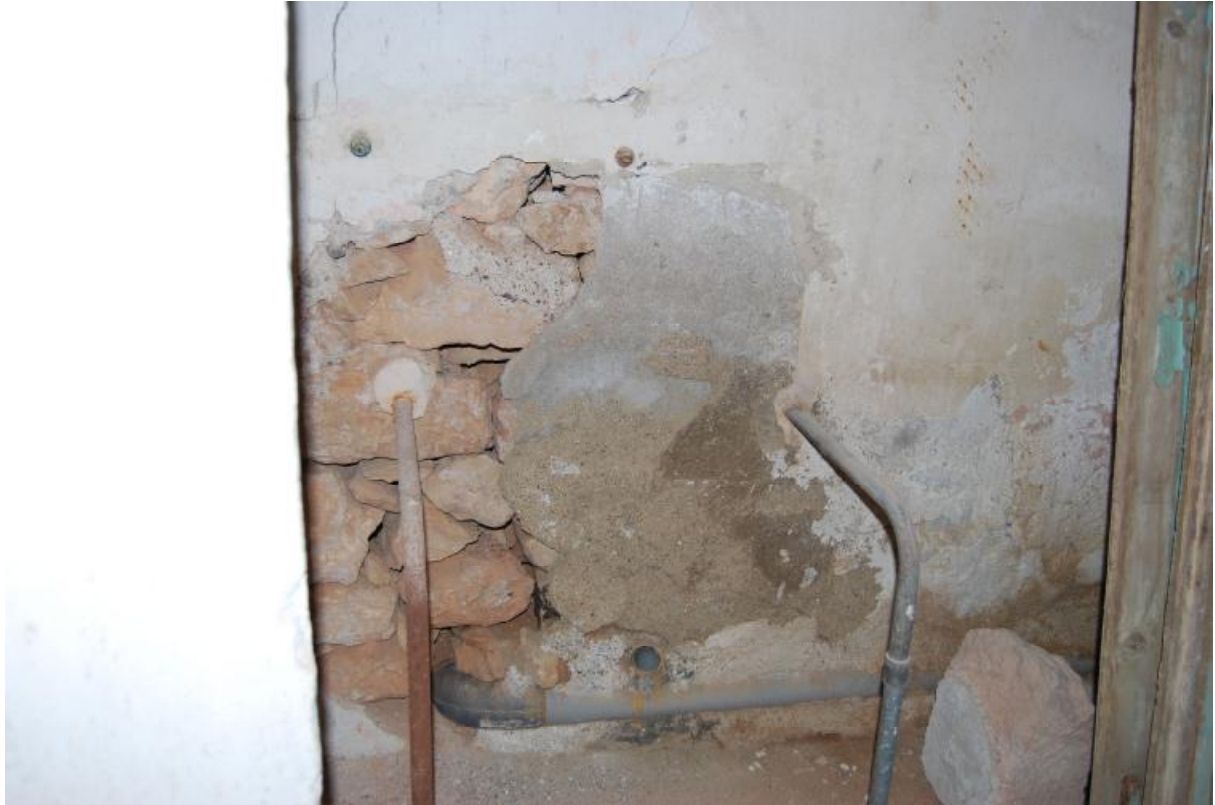
ΕΙΚΟΝΑ 59 : ΣΩΛΗΝΩΣΕΙΣ ΣΤΟ Β΄ΚΤΙΡΙΟ
