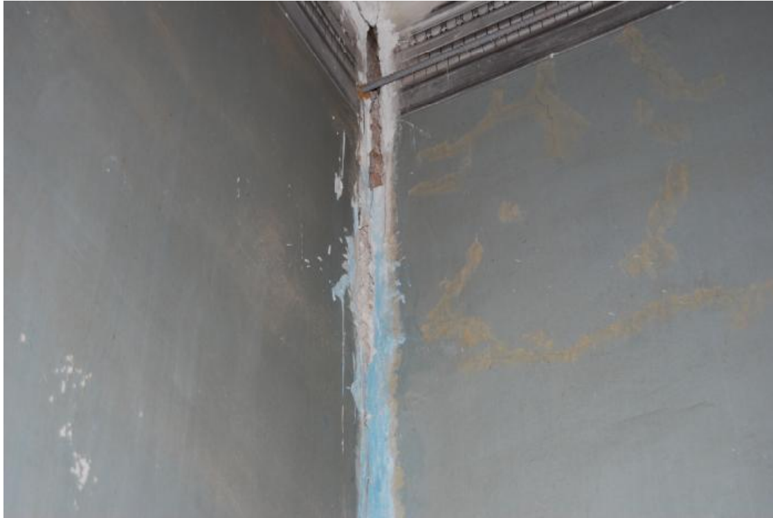
ΕΙΚΟΝΑ 15:ΡΩΓΜΗ ΣΕ ΤΟΙΧΟ ΣΤΟΝ Β'ΟΡΟΦΟ
