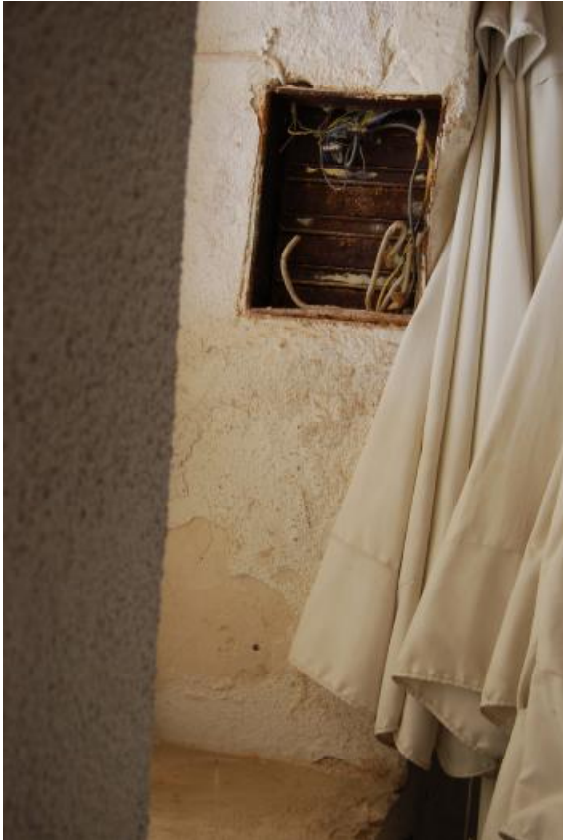
ΕΙΚΟΝΑ 61 : ΗΛΕΚΤΡΟΛΟΓΙΚΕΣ ΕΓΚΑΤΑΣΤΑΣΕΙΣ ΚΑΤΑΣΤΗΜΑΤΩΝ
