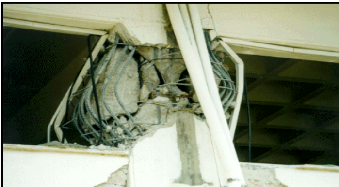
Εικόνα 1.5. Αστοχία κολώνας 5όροφης οικοδομής (έτος κατασκευής 1997) που προκλήθηκε από το σεισμό της 7ης Σεπτεμβρίου 1999 (M=5.9) (Anastasiadis et al., 1999)
