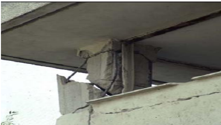
Εικόνα 1.6. Αστοχία κοντού υποστυλώματος
