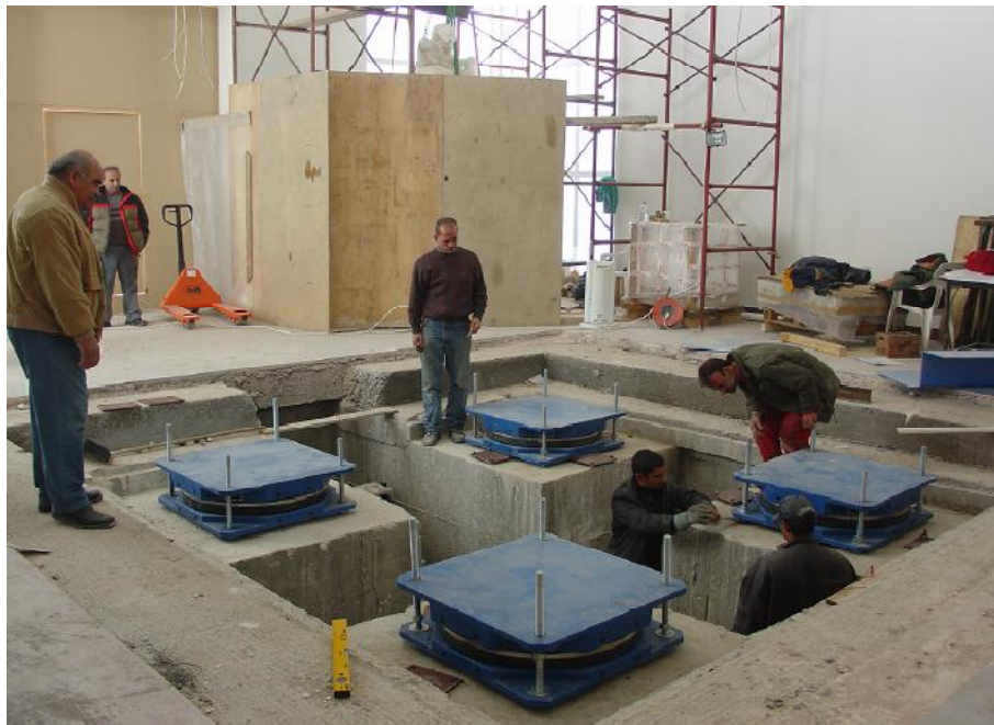
Εικόνα 6.12. Βάση της Σεισμικής Μόνωσης
