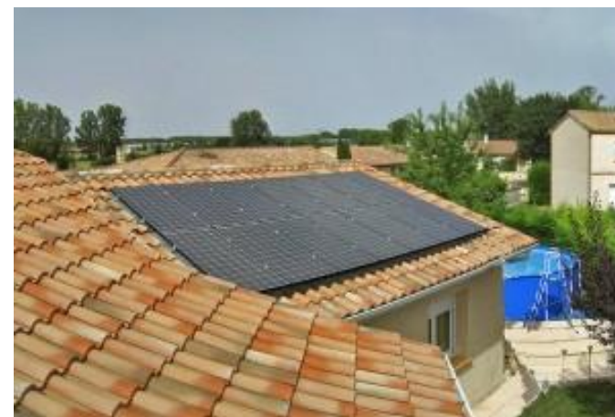
Εικόνα 51: Φωτοβολταϊκό πλαίσιο σε στέγη.
