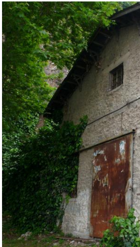
Εικ. 66: Ο κισσός που έχει αναπτυχθεί στην ανατολική πλευρά
