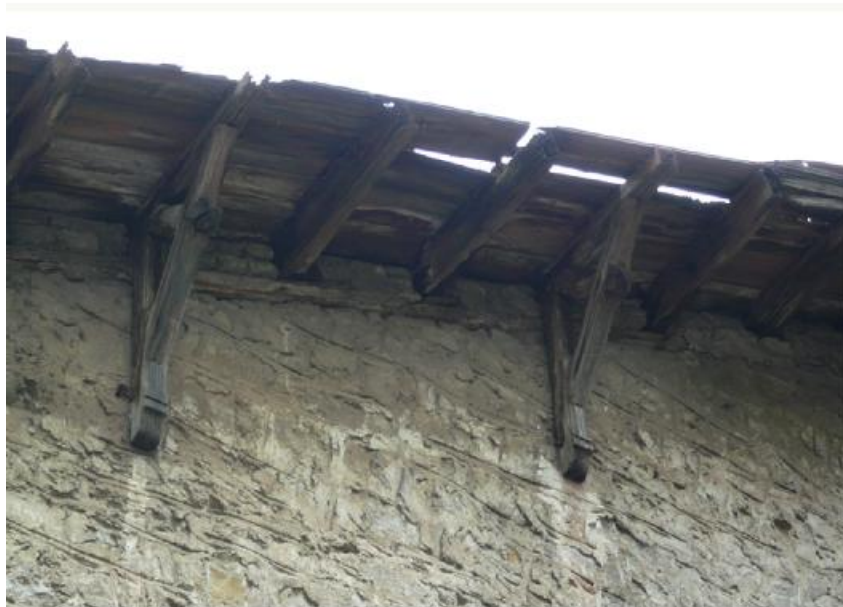
Εικ. 74: Ενδεικτικές βλάβες της στέγης
