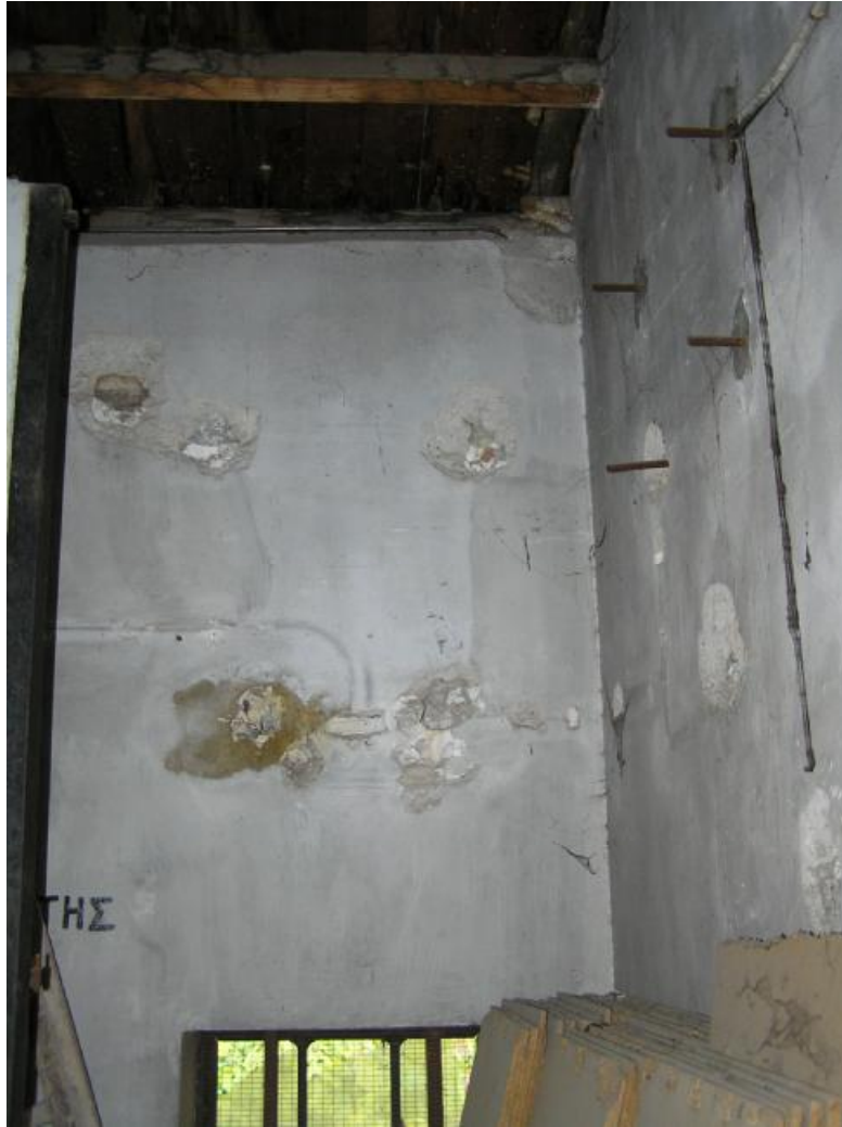
Εικ. 70: Τοπική εμφάνιση υγρασίας και σαθροποίηση επιχρίσματος στο πατάρι
