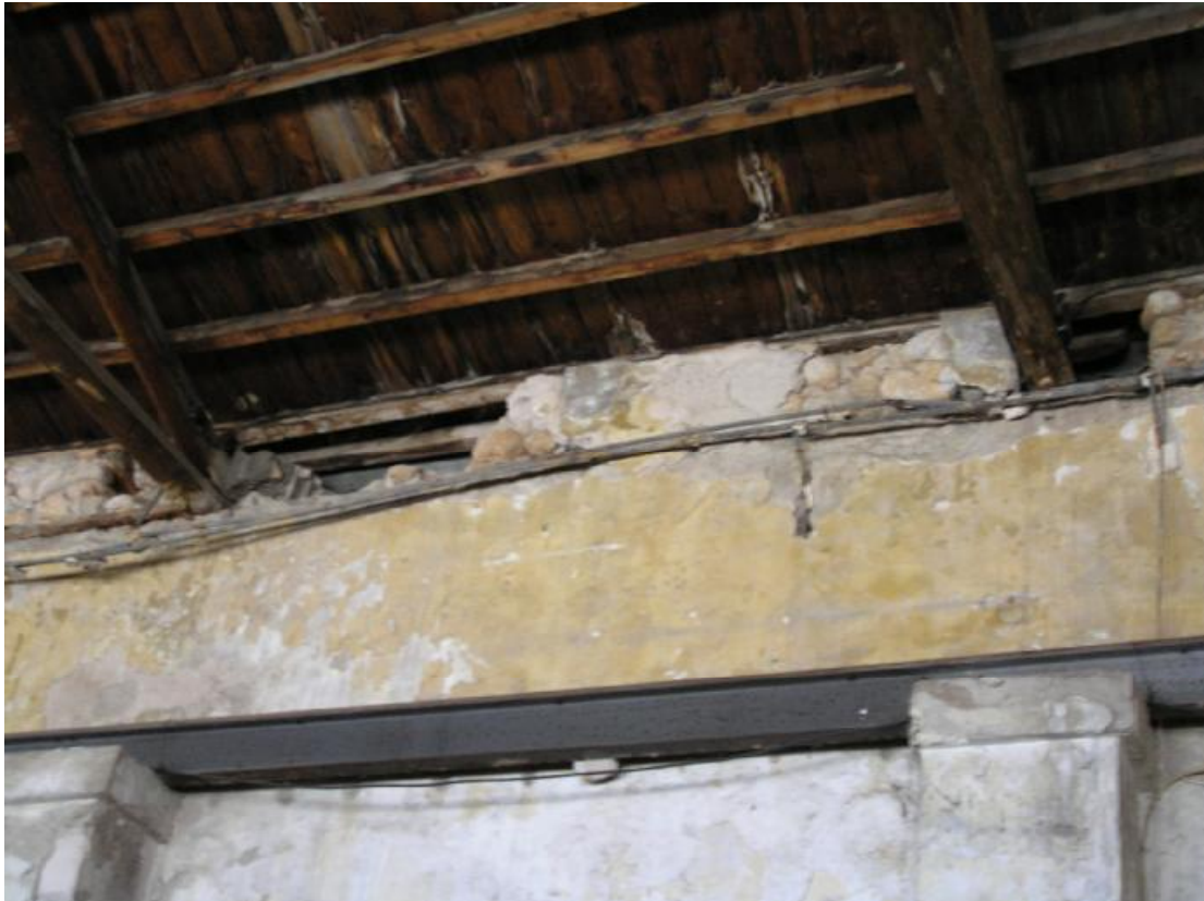
Εικ. 67: Βλάβες λιθοδομής νότιου τοίχου. Αριστερά παρατηρείται πτώση λίθων και δεξιά πτώση επιχρίσματος και έλλειψη συνοχής των λίθων.
