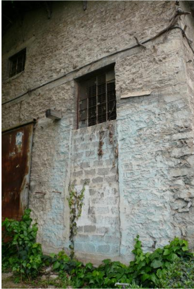
Εικ. 63 Εξωτερική όψη του παραθύρου της ανατολικής πλευράς και της τωρινής του κατάστασης
