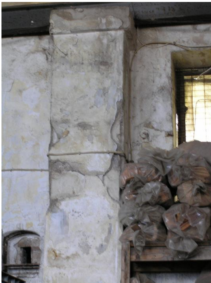
Εικ. 69: Πτώση επιχρίσματος σε ημιπεσσό
