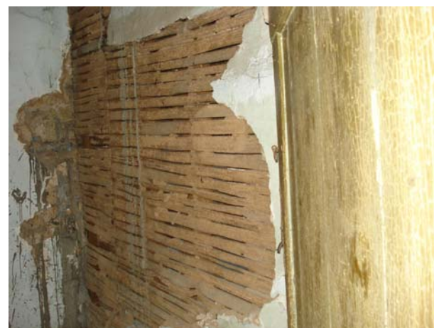
Εικ.41: Κατάρρευση επιχρίσματος στο χώρο Α7.
