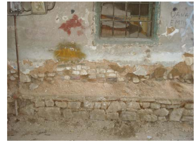
Εικ.23: Φθορές στην αργολιθοδομή.
