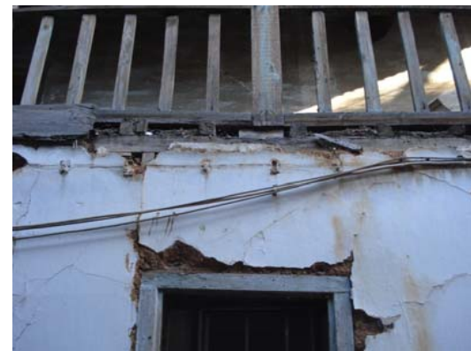
Εικ.18: Στήριξη μεσοπατώματος σε ξύλα που «τρέχουν» στην κορυφή της τοιχοποιίας.
