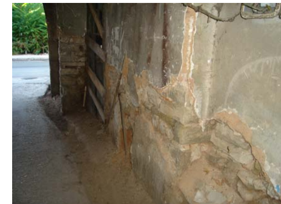
Εικ.10: Υφιστάμενη κατάσταση τοιχοποιίας στο ισόγειο της ανατολικής πτέρυγας,
