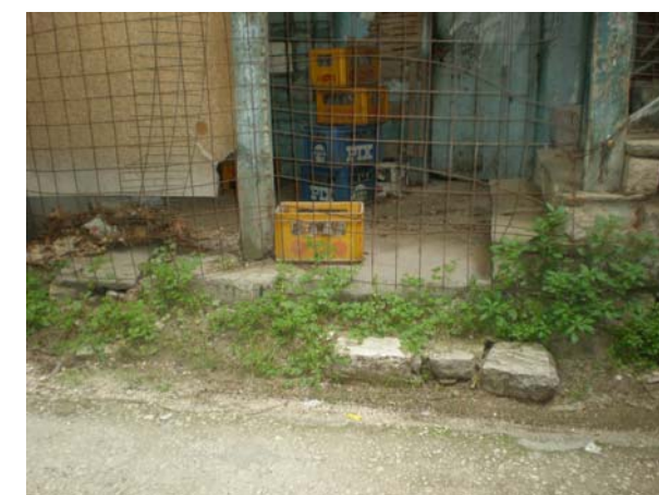
Εικ.22: Δάπεδο από τσιμέντο μπροστά από το χώρο Π10.
