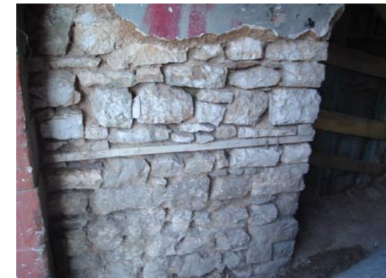
Εικ.19: Ξυλοδεσιές στην αργολιθοδομή.
