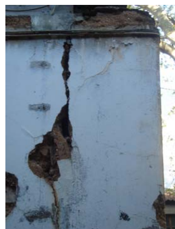
Εικ.24: Διαμπερή ρωγμή.
