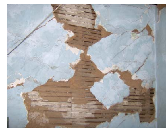
Εικ.46: Φθορές στο εσωτερικό του χώρου Α6.
