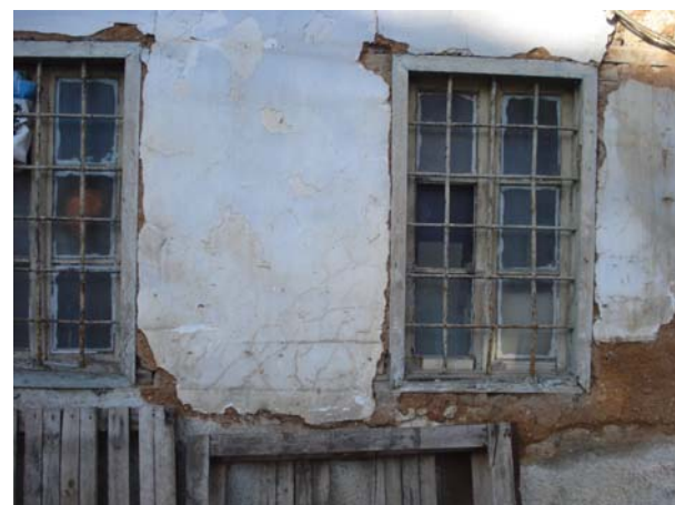
Εικ.14: Σημερινή κατάσταση ξύλινων παραθύρων ισογείου.
