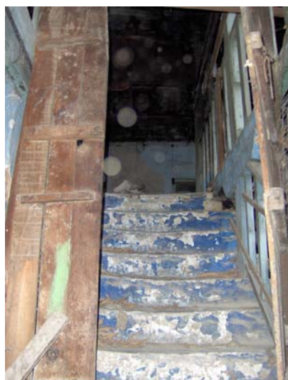
Εικ.31: Παραμόρφωση των λίθων της σκάλας.
