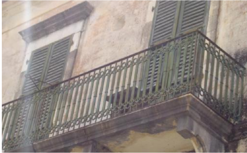
Εικόνα 67: Κιγκλιδώμα εξώστη σε κτήριο στην Αγία Ευφημία προσωπικό αρχείο 20/09/09
