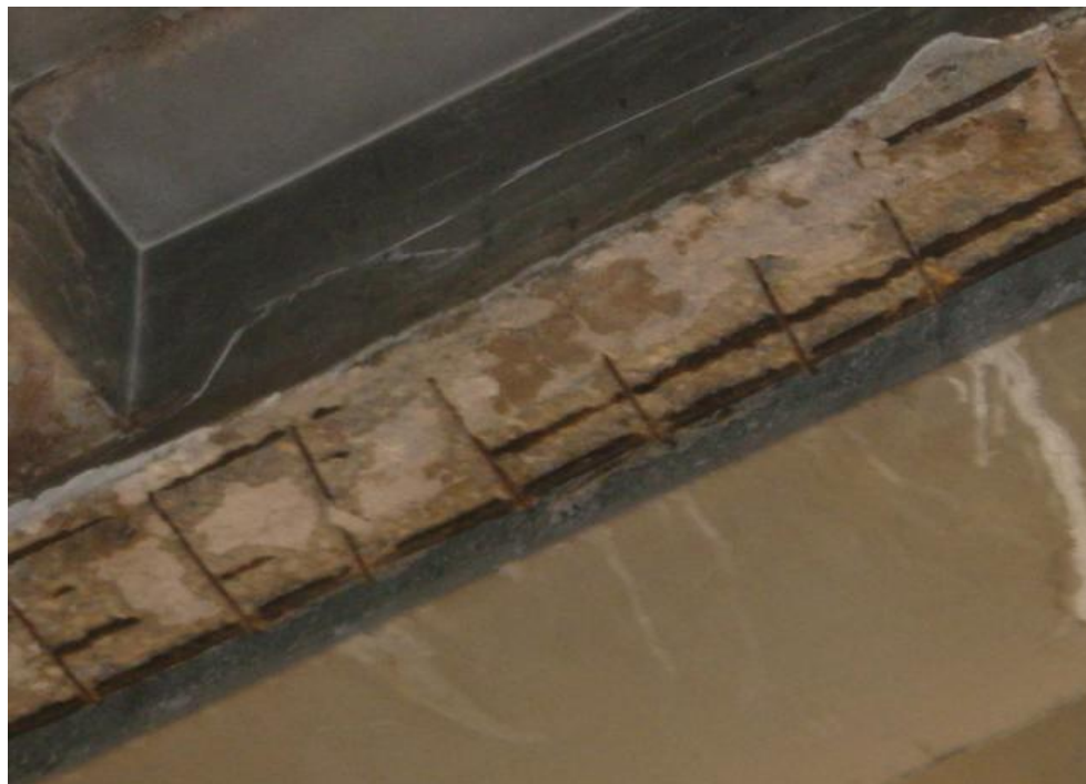
ΦΤ.17 Φθορές του οπλισμού των δοκών.
