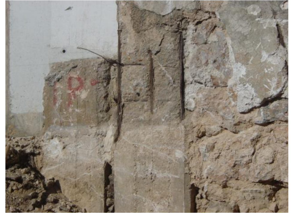
ΦΤ.20 Διάβρωση του οπλισμού, στις όψεις του κτιρίου
