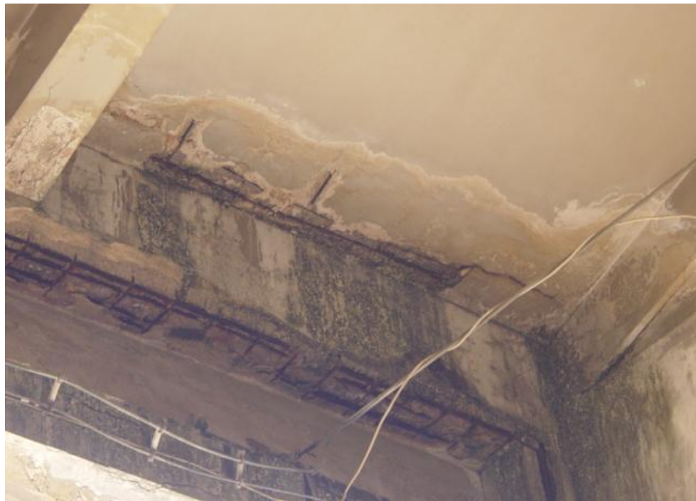
ΦΤ.15 Φθορές του οπλισμού των δοκών.
