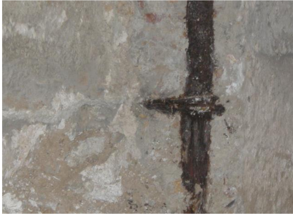
ΦΤ.19 Εσωτερική λήψη για την διάβρωση του οπλισμού.
