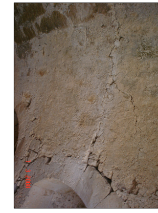
Ρωγμή σε κόγχη Φ 06.9
