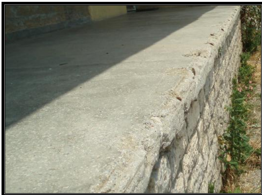
Εικ. 27β ΔΙΑΒΡΩΣΗ ΣΚΥΡΟΔΕΜΑΤΟΣ.
