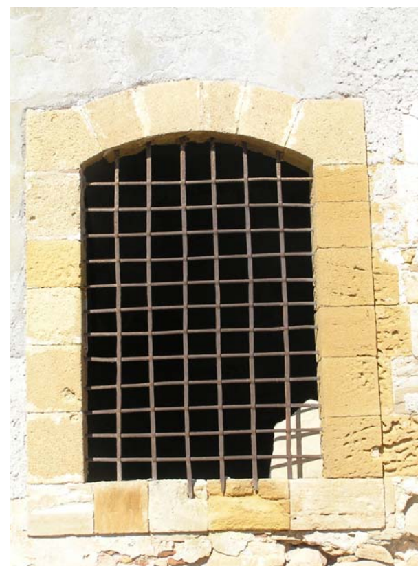
Εικ.60 Λεπτομέρεια κουφώματος Νότιου κλίτους .Οξειδωση μεταλλικής σιδεριάς.
