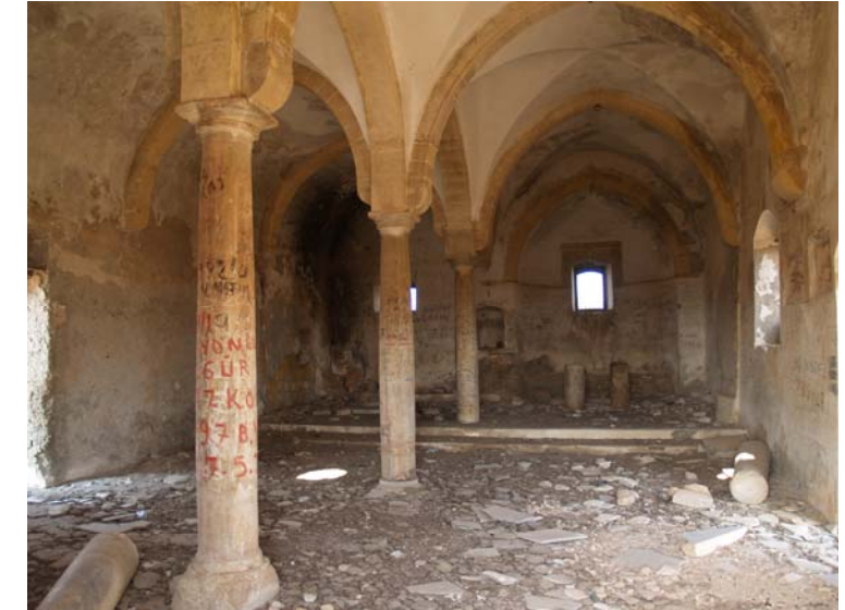
Εικ.39 Εσωτερική άποψη του ναού προς Δυσμάς. Ριγμένοι κακόβουλα οι δυο κίονες στο έδαφος.
