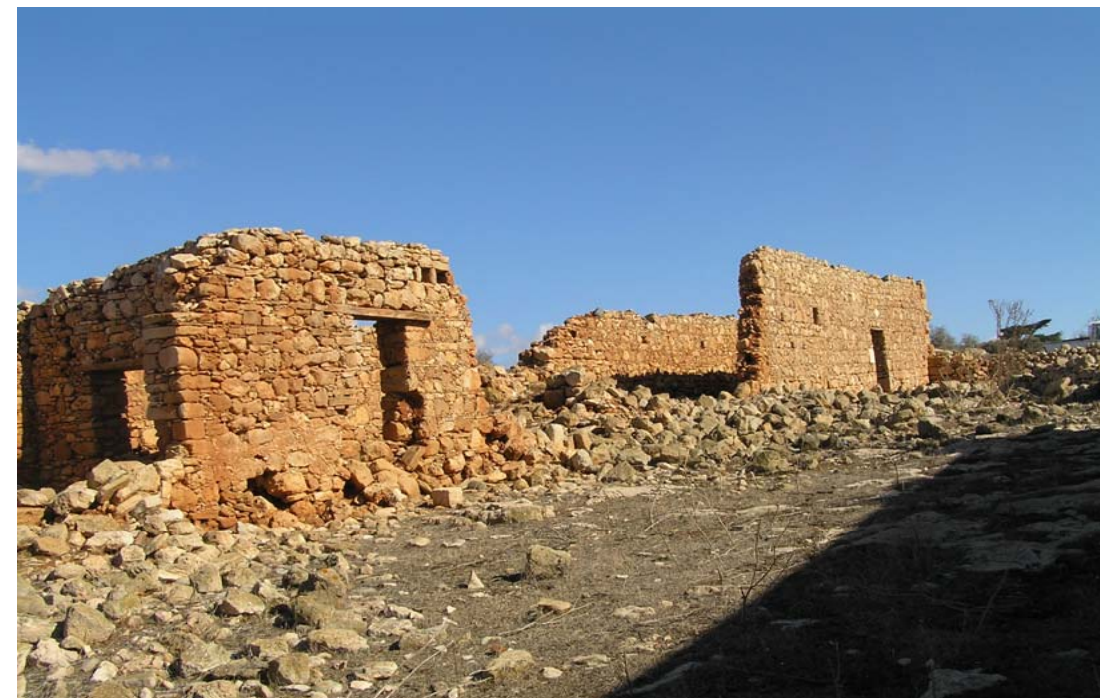
Εικ.67 Νοτιοδυτική άποψη των αποθηκών. Απώλεια μεγάλου τμήματος τοιχοποιίας όπου έχει καταρρεύσει.
