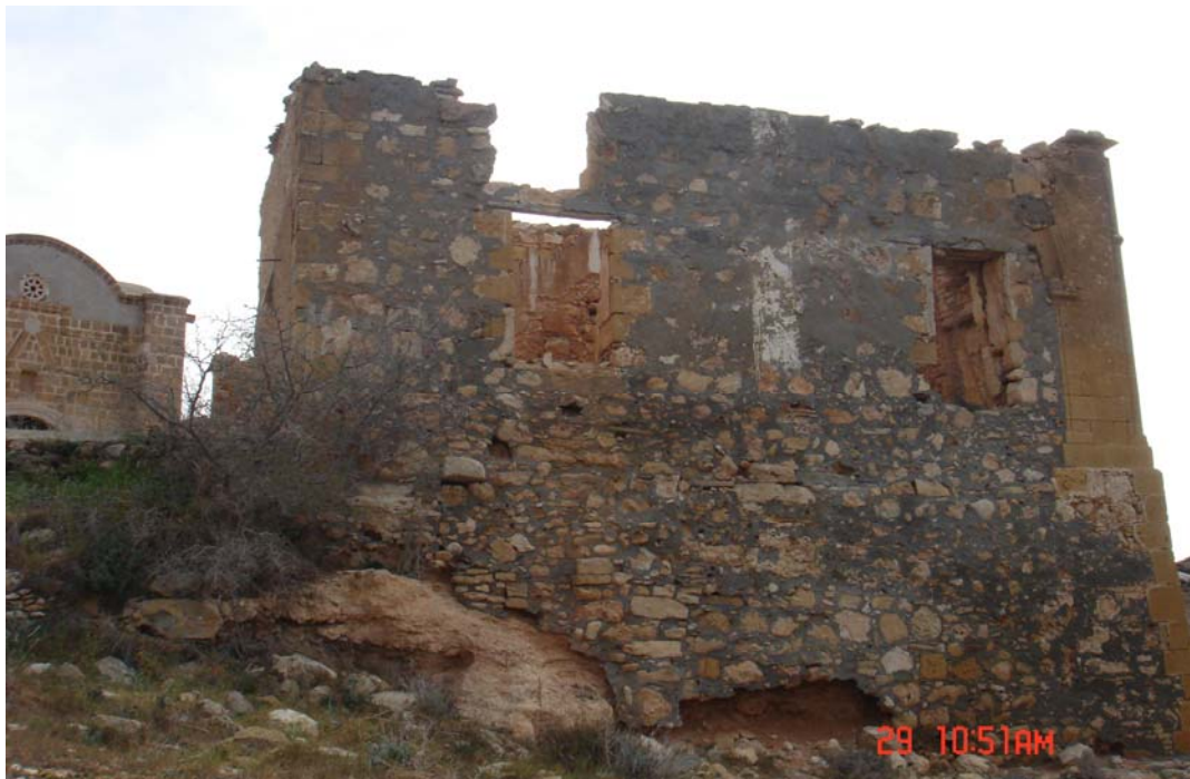
Εικ.10 Δυτική άποψη του κτίσματος (άστοχες επεμβάσεις στην τοιχοποιία).
