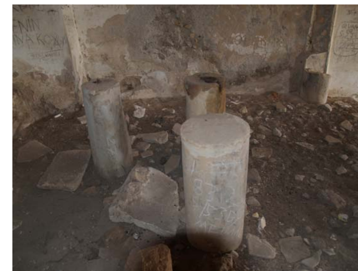
Εικ.42 Λεπτομέρεια από τα απομεινάρια της Αγίας Τράπεζας την οποία έχουν καταστρέψει.
