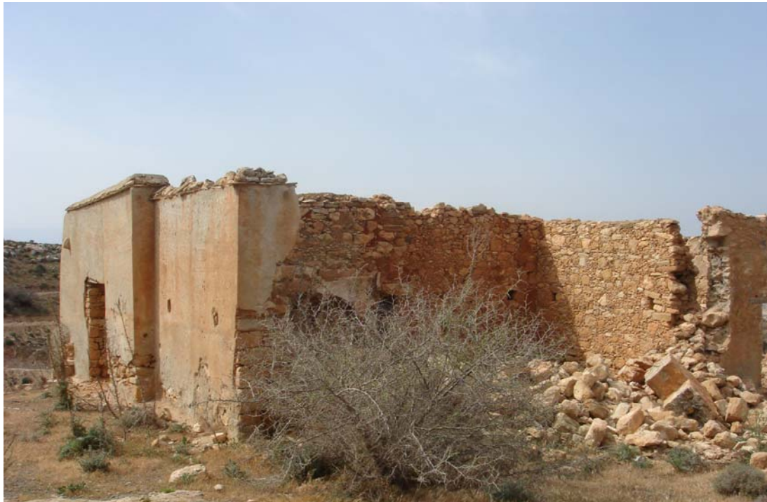
Εικ.8 Βορειοανατολική άποψη των κελιών Τμηματική κατάρρευση τοιχοποιίας και Απώλεια τμήματος οροφής.
