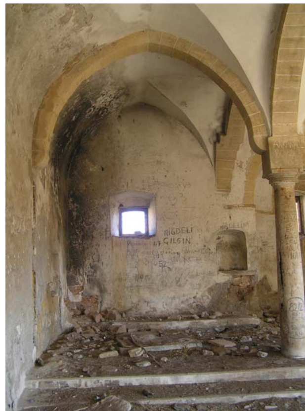
Εικ.54 Γενική άποψη του Βόρειου κλίτους .Σημάδια καταστροφής και βεβήλωσης.
