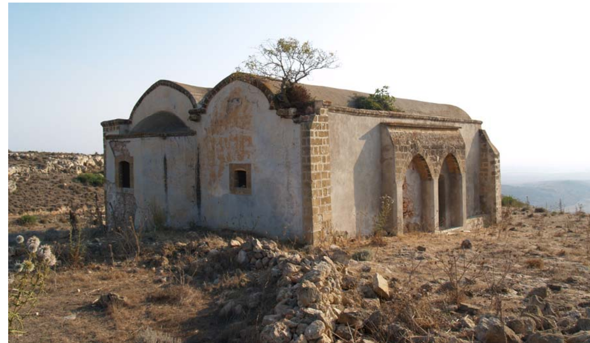
Εικ.24 Βορειοανατολική άποψη του ναού, Νότιο και Βόρειο κλίτος. Διακρίνεται στο Νότιο κλίτος το τετρασφαιρίο της αψίδας ιερού καθώς και ανάπτυξη βλάστησης στην στέγη του Βόρειου κλίτους. (Σημάδια εγκατάλειψης και ερείπωσης).
