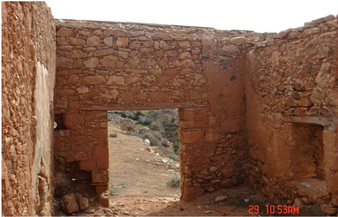
Εικ.21 Εσωτερική άποψη του ηγουμενείου του χώρου K01 . Είσοδος του χώρου απέναντι. Εμφανής ο τρόπος της τεχνικής οικοδόμησης της τοιχοποιίας.
