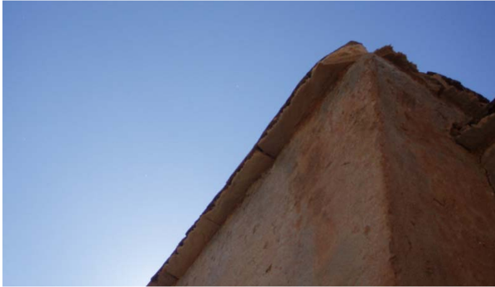
Εικ.16 Λεπτομέρεια κορδώματος οροφής (απομεινάρια) από το Ηγουμενείο
