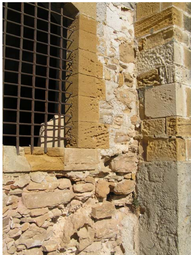
Εικ.61 Λεπτομέρεια κουφώματος Νότιου κλίτους . Οξειδωση μεταλλικής σιδεριάς και σπηλαίωση ψαμμίτη λόγω υγρασίας.
