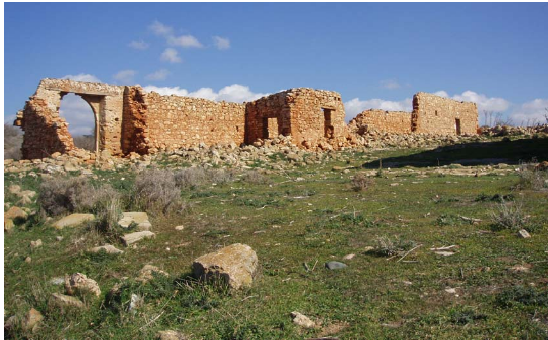
Εικ.64 Γενική άποψη των αποθηκών από Νοτιοδυτικά. Απώλεια τμήματος οροφής και τμηματική κατάρρευση τοιχοποιίας .
