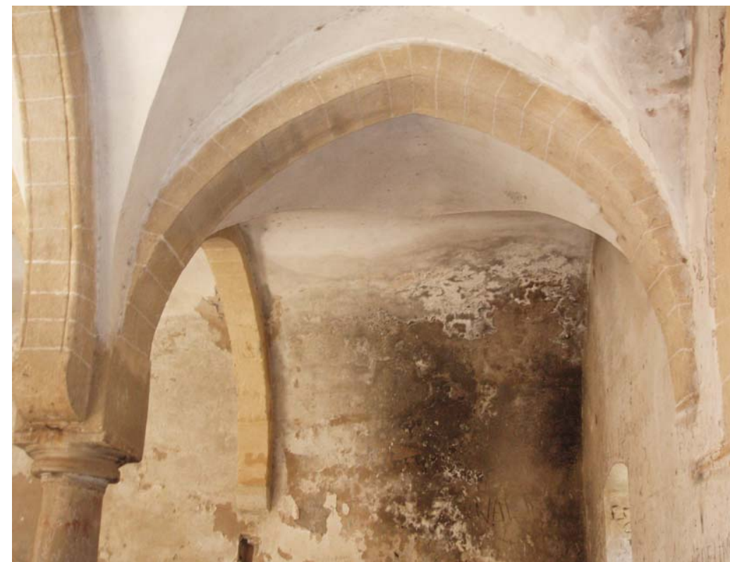
Εικ.50 Λεπτομέρεια της 4 ης αψίδας από την Τοξοστοιχία που φέρεται στους τέσσερις κίονες. Σημάδια καταστροφής στο βάθος από πυρκαγιά.
