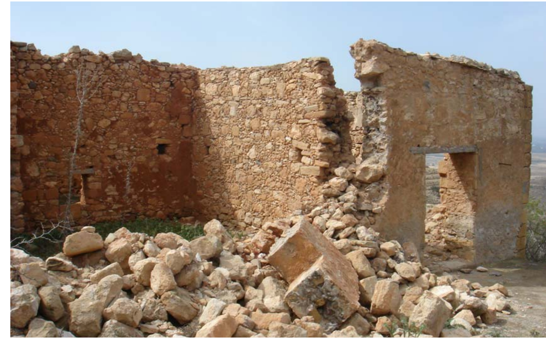
Εικ.9 Τμηματική κατάρρευση τοιχοποιίας Βορειοανατολικά του κτίσματος.
