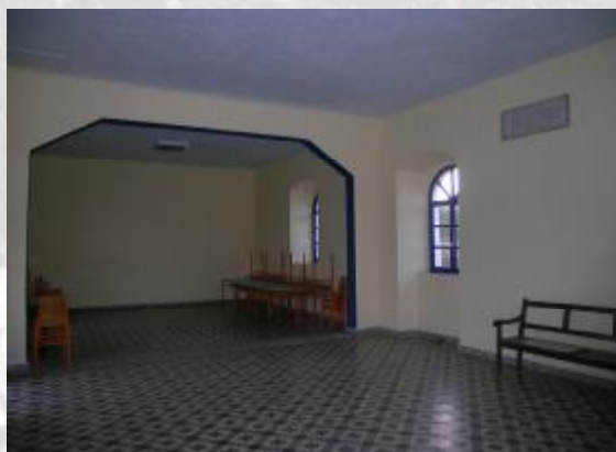
Εικόνα 52: Αποψη του εσωτερικού του σχολείου
