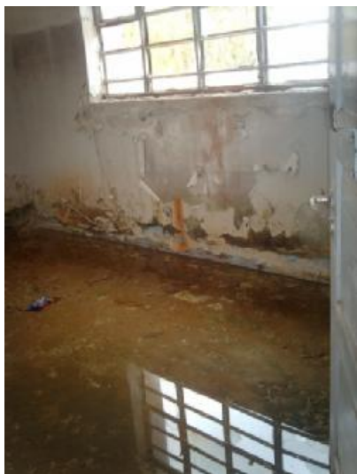
Εικ.49 λιμνάζοντα όμβρια ύδατα στον όροφο
