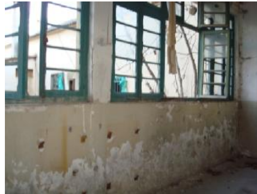
Εικ. 46 σημάδια υγρασίας στην τοιχοποιία
