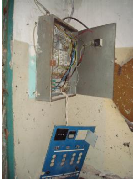
Εικ.51 κεντρικός ηλεκτρολογικός πίνακας
