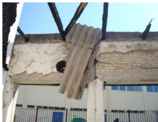
Εικ.53 φθορές οπτοπλινθοδομής
