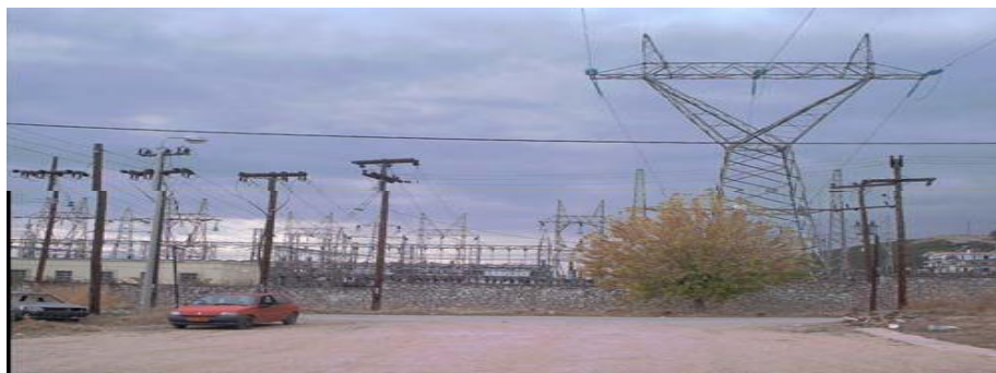
ΕΙΚΟΝΑ 2.7 υποσταθμοί υψηλής τάσης ( www.eaee.gr (2009))
