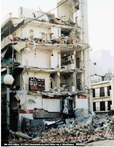
εικόνα 1.7 Κατάρρευση πολυκατοικίας(σεισμός Πάρθηκα 1999)
