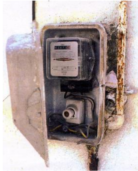
Τα κουτιά μέτρησης βρίσκονται συχνά σε εύκολα προσβάσιμα σημεία και σε κακή κατάσταση ( Σχολείο πόλης Κορθίου, στο νησί Άνδρος, 1988)
