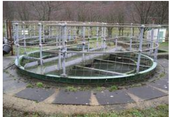
Εικ 5. Δεξαμενή καθίζησης
