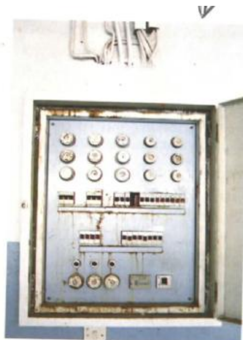
Νερά στον πίνακα διανομής σχολείου
