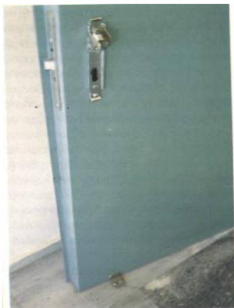
Πόρτα καθυστέρησης πυρκαγιάς καθλωμένη με βίδες στο έδαφος.
