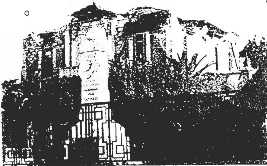
Τὸ ἴδιο κτίριο μετὰ τὸ σεισμό. Φωτογράφος Σ. Πεταλά
