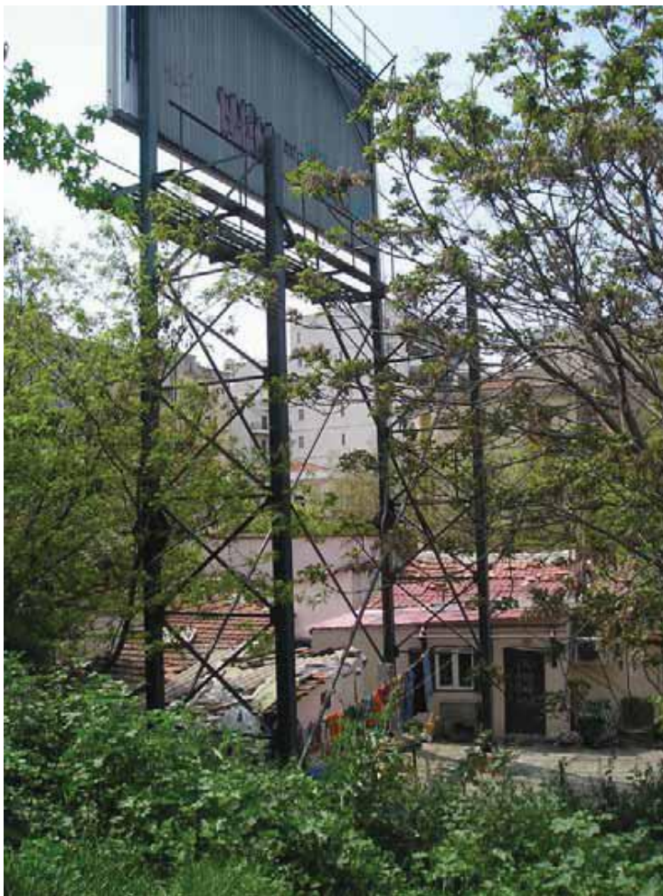
Εικόνα 33 Μεταλλική υπερκατασκευή διαφημιστικής πινακίδας επί της οδού Κ.Καραμανλή αμφίβολης στατικής επάρκειας και κατά παράβαση των νομικών διατάξεων
