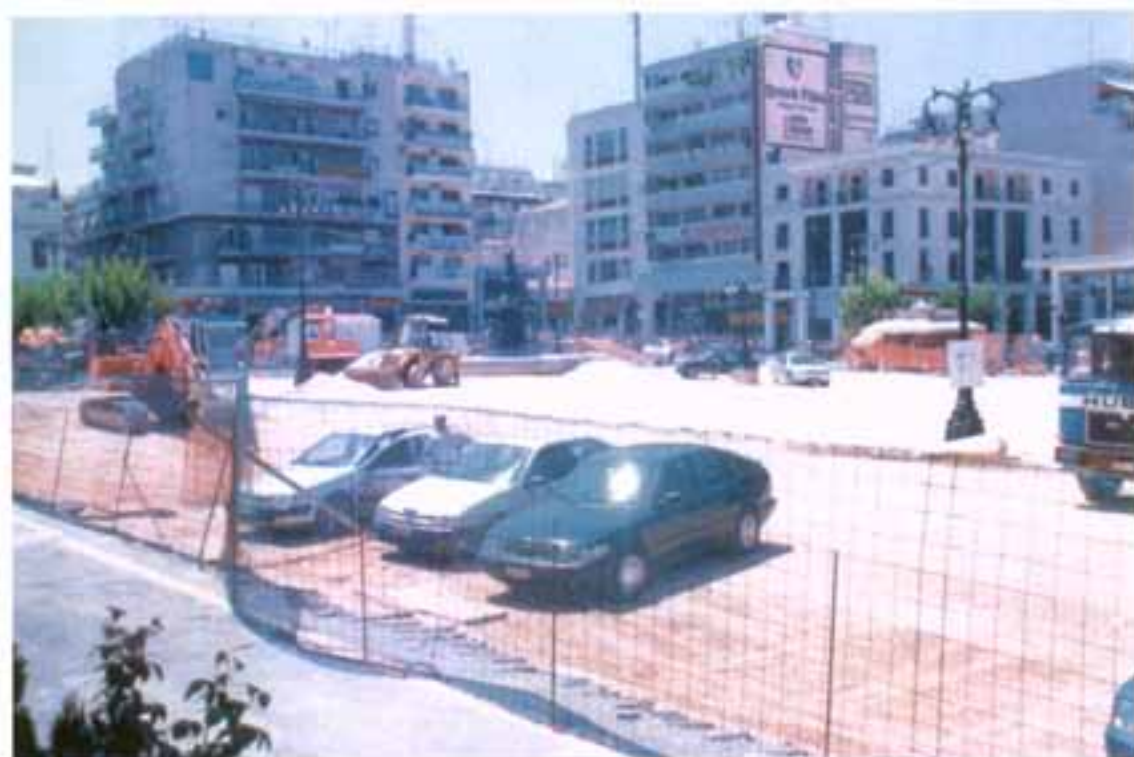
Εικόνα 6 Τα έργα που εκτελούνται για την ανακατασκευή της Πλατείας Γεωργίου εμποδίζουν την κίνηση τόσο των αυτοκινητιστών όσο και των πεζών.
