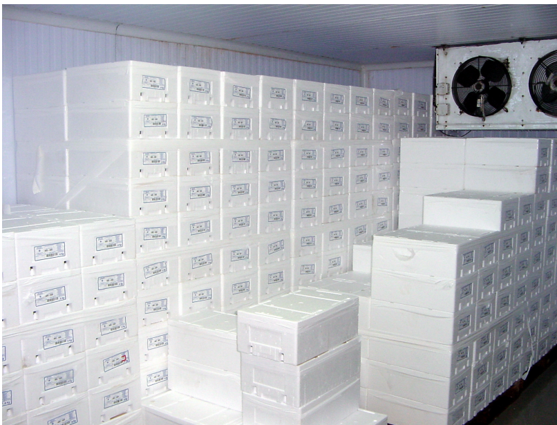
Εικόνα 8: Παλετοποιημένα κιβώτια (φελιζόλ), μέσα σε ψυκτικό θάλαμο
