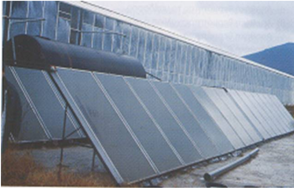
Εικόνα 3.1: Ηλιακός συλλέκτης βιομηχανικού τύπου τοποθετημένος έξω από θερμοκήπιο
