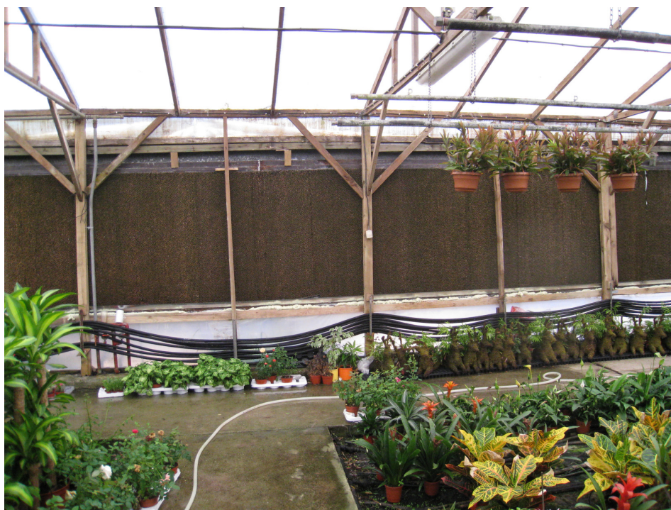
Εικόνα 9. Σύστημα ψύξης του χώρου του θερμοκηπίου που καταναλώνει ηλεκτρική ενέργεια. Διακρίνονται στη νότια πλευρά του οι κυψελίδες νερού που λειτουργούν σαν εναλλάκτης θερμότητας. Ο εισερχόμενος αέρας διέρχεται μέσα από αυτές στο χώρο του θερμοκηπίου και ψύχεται.
