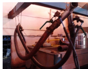
(12) « Τρόμπες σύνδεσης με αντλίες»
