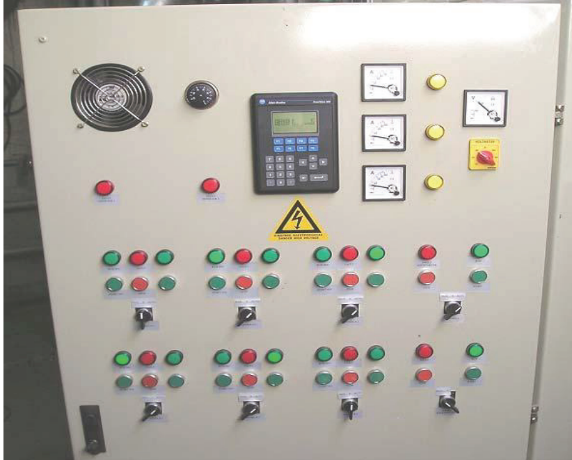
Εικόνα 18 Μπροστινή πλευρά του ηλ. πίνακα
