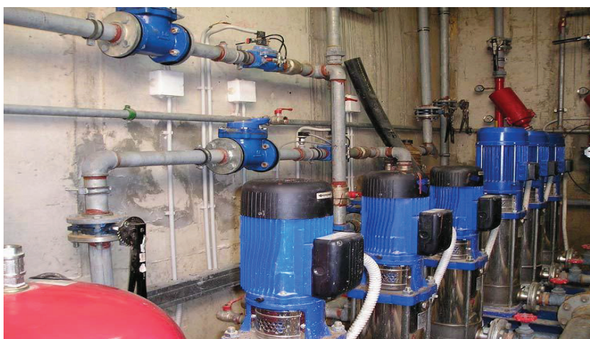
Εικόνα 14 Μερική άποψη του αντλιοστασίου
