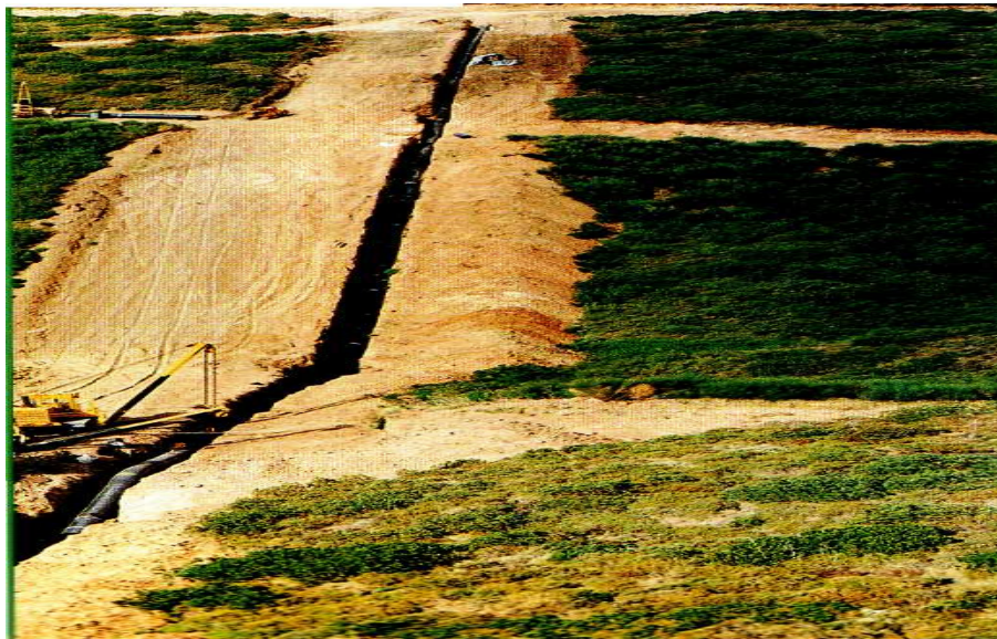
Εικόνα 48. Αγωγός μεταφοράς φυσικού αερίου
