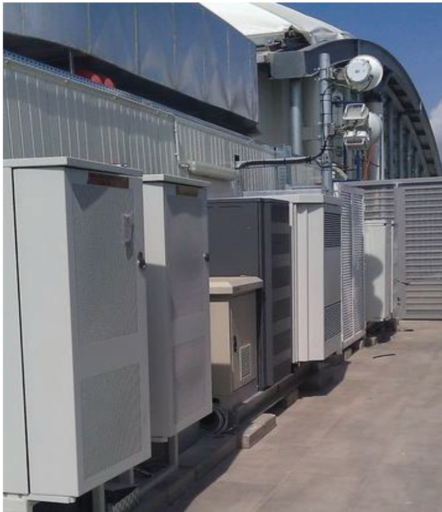
Εικόνα 4.13: BTS Room - Θέση μηχανημάτων και κατόπτρων στο δάμα του κτιρίου
