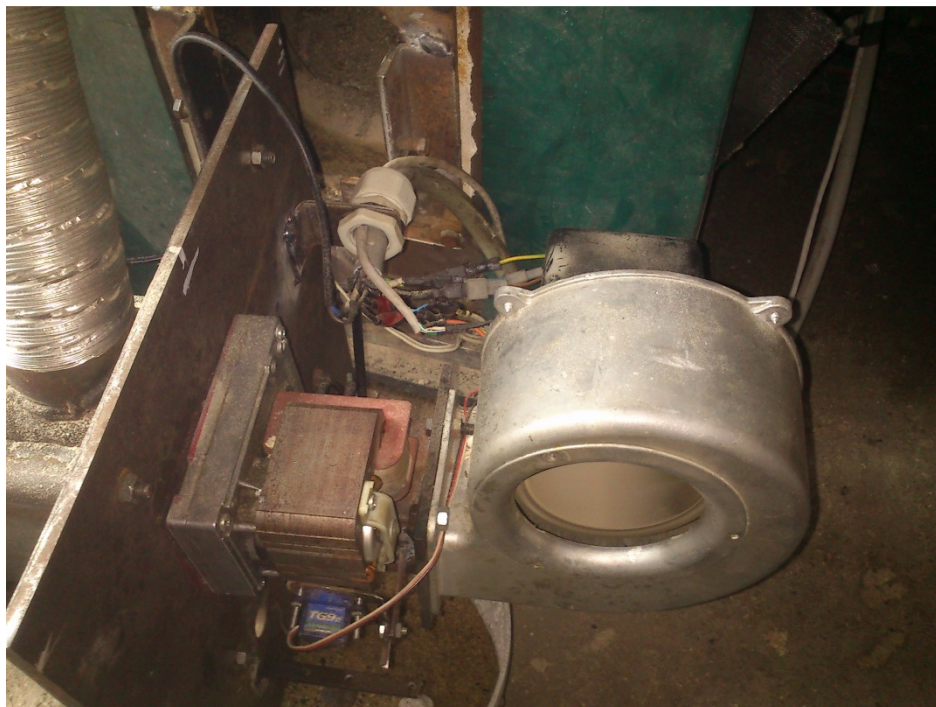
Εικόνα 24 - Μηχανικά μέρη καυστήρα πέλλετ
